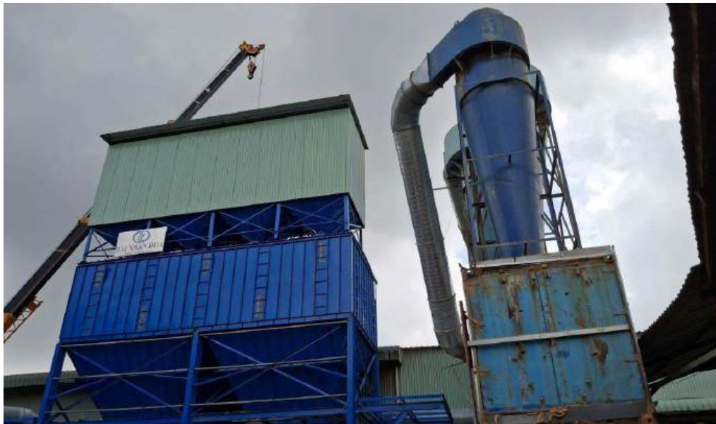
Hình 20. Hệ thống thu gom và xử lý bụi tập trung phân xưởng thớt
