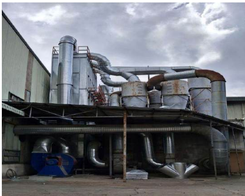
Hình 16. Hệ thống thu gom và xử lý bụi tập trung phân xưởng 2
