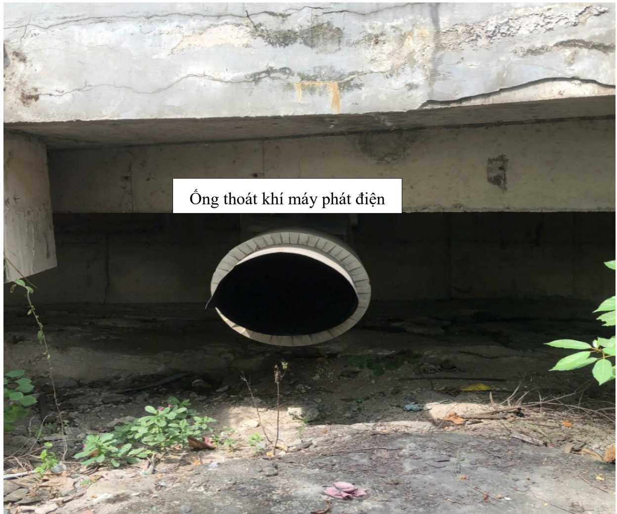
Hình 24. Hình ảnh ống xả của ống thoát khí thải máy phát điện giai đoạn 1A, 1B (điển hình)
