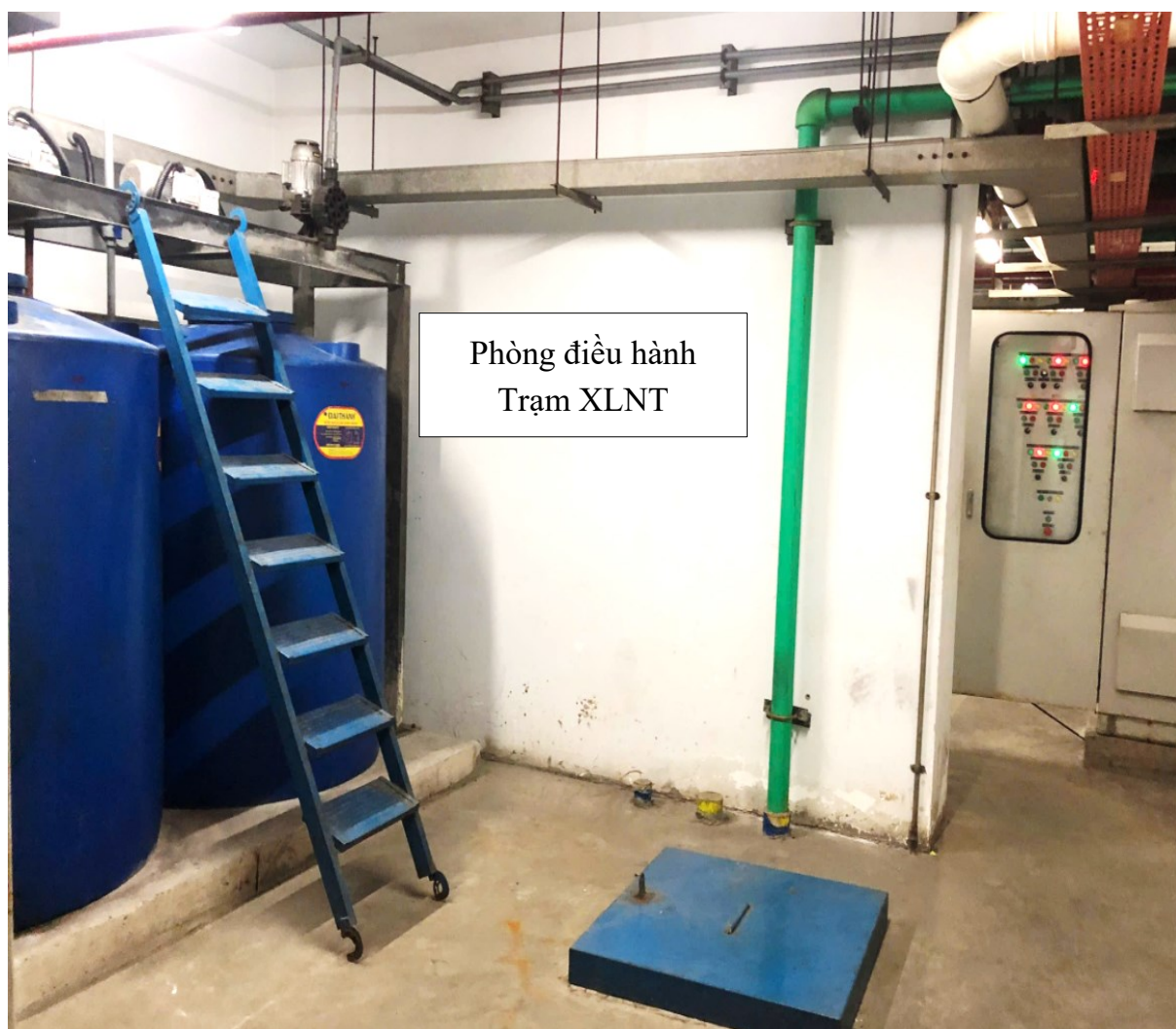
Hình 17. Phòng điều hành của Trạm xử lý nước thải công suất 1.255,5 m 3 /ngày đêm
