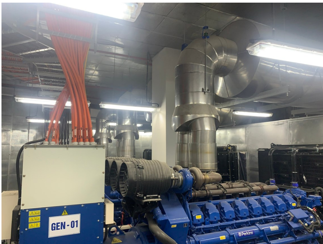
Hình ảnh 3 máy phát điện đặt tại tầng hầm
