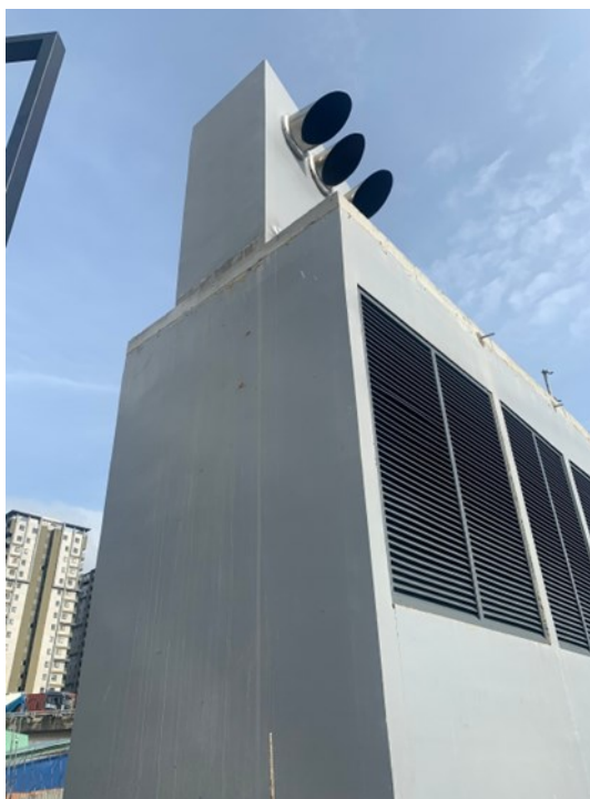
3 ống thoát máy phát điện
