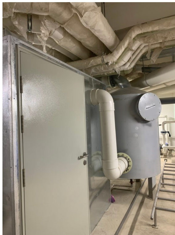
Hình 27. Tháp xử lý mùi của trạm XLNT công suất 606,7 m 3 /ngày
