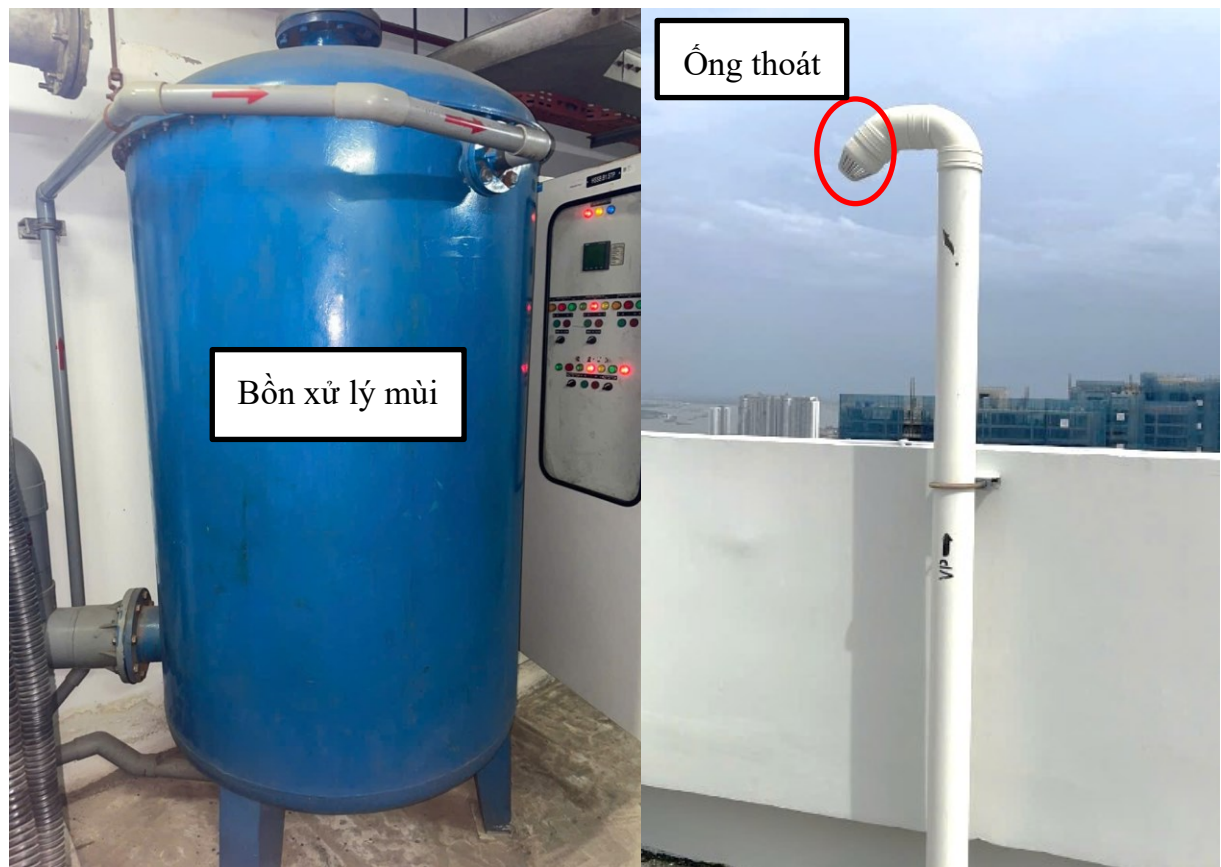
Hình 26. Bồn xử lý mùi của trạm XLNT công suất 1.255,5 m 3 /ngày
