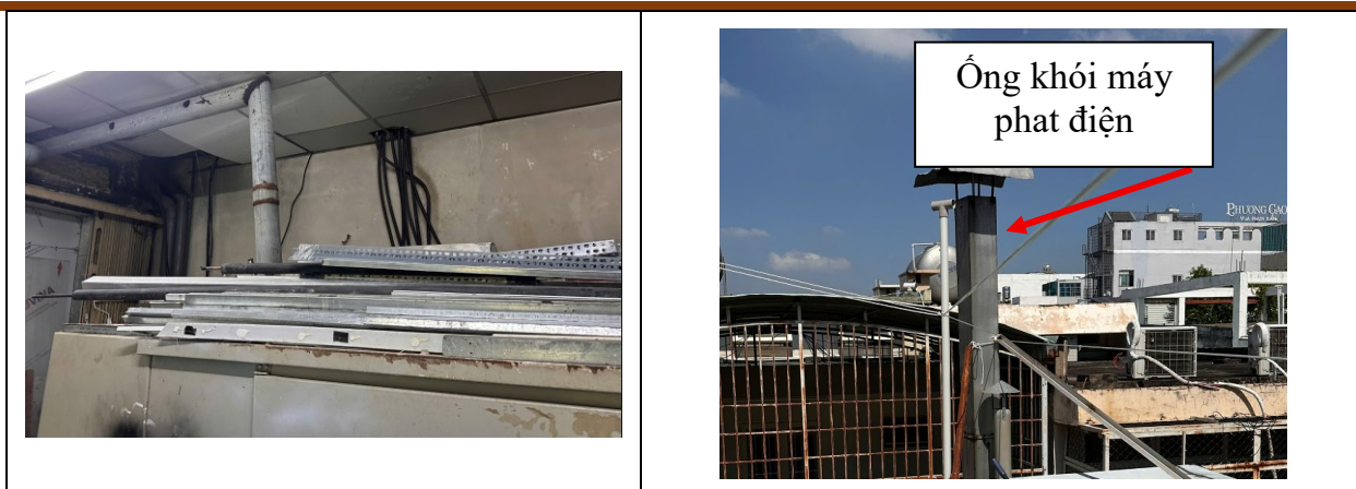
Hình 3. 8. Vị trí máy phát điện và Ống khói máy phát điện dự phòng, công suất 125 kVA đặt tại căn nhà 266A
