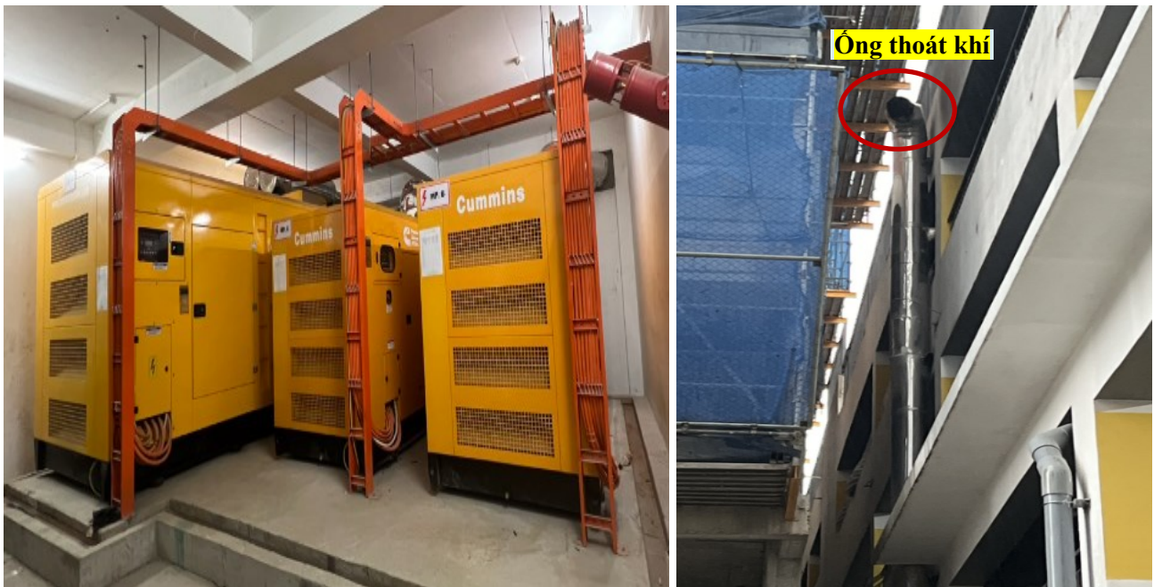
Hình 19. Máy phát điện đã được lắp đặt
