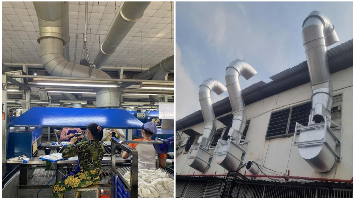
Hình 12 - Hệ thống thu gom, thoát khí hơi dung môi keo
