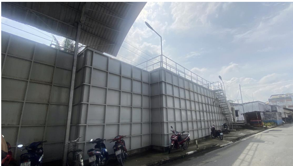
Hình 10 - Hình ảnh công trình hệ thống xử lý nước thải của cơ sở
