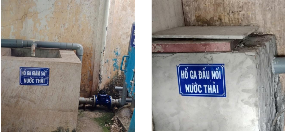
Hình 7 - Hình ảnh hố ga đầu nối nước thải
