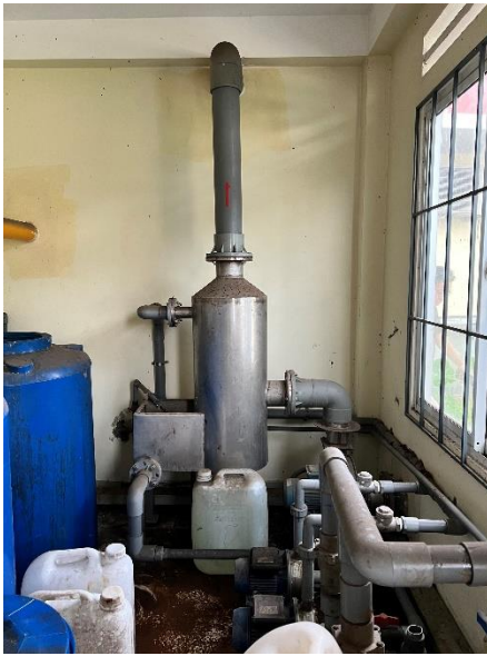
Tháp xử lý mùi bên trong NHĐH HTXLNT
