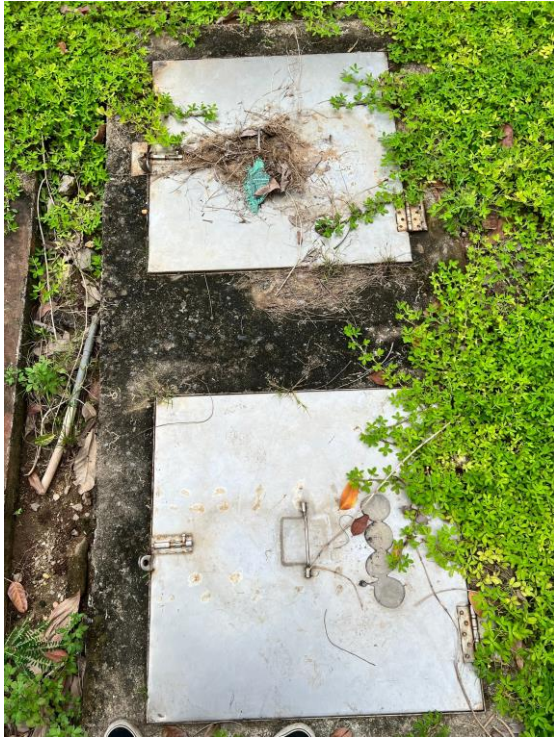
Bể điều hoà
