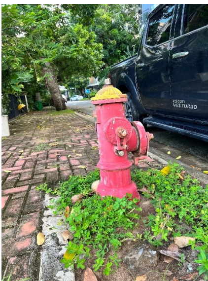
Hình 3.18. Trụ chữa cháy ngoài nhà
