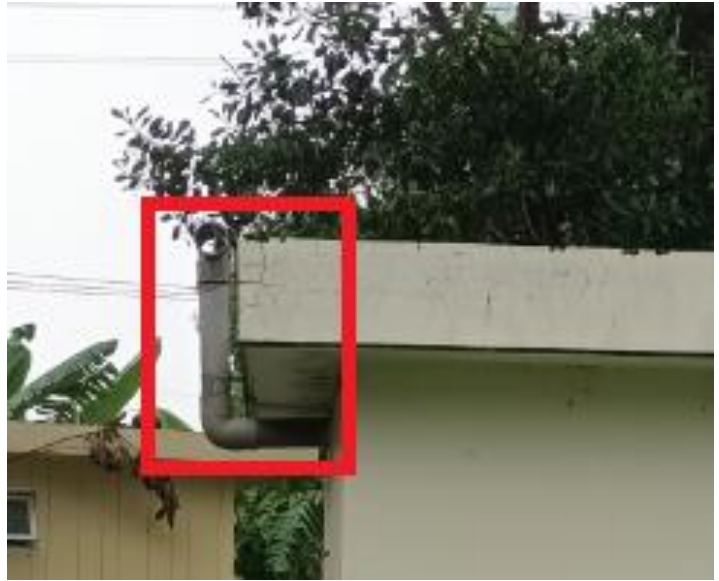
Ống thải sau xử lý của hệ thống xử lý mùi từ HTXLNT
