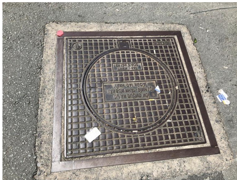
Hình 3. 3. Hố ga thoát nước mưa ra cống thoát nước thành phố
