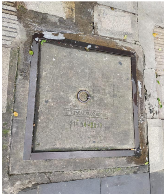
Hố ga đầu nối nước mưa
