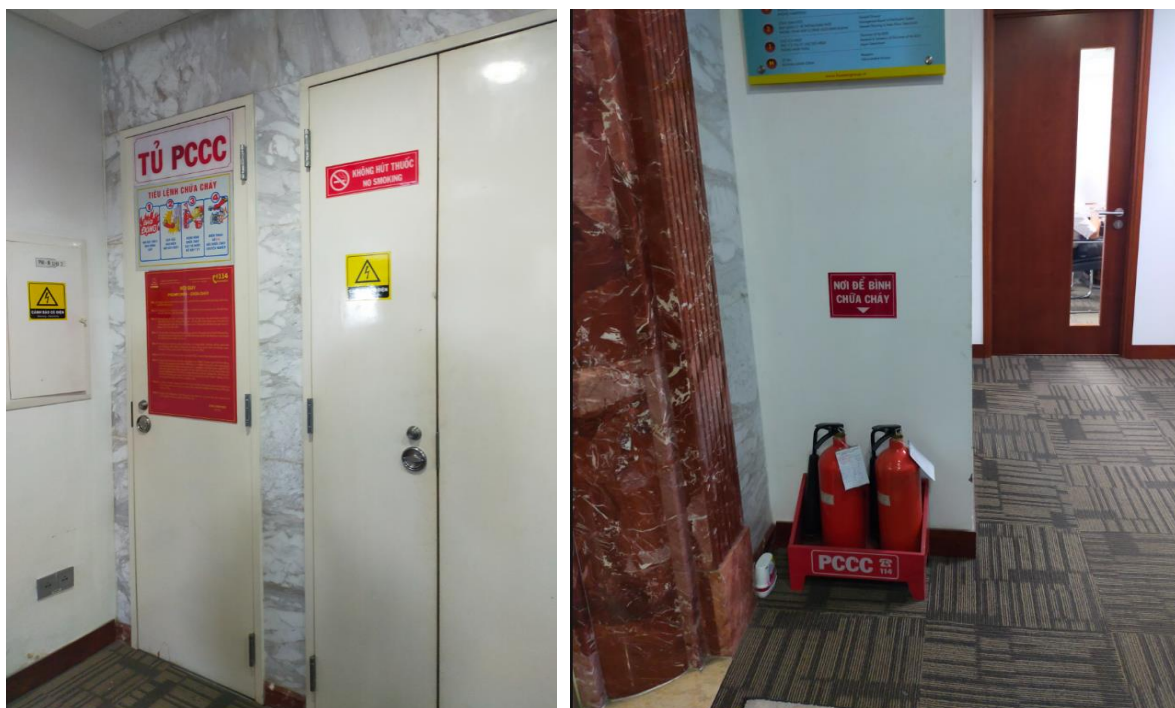
Hình 11. Thiết bị phòng cháy chữa cháy tại cơ sở
