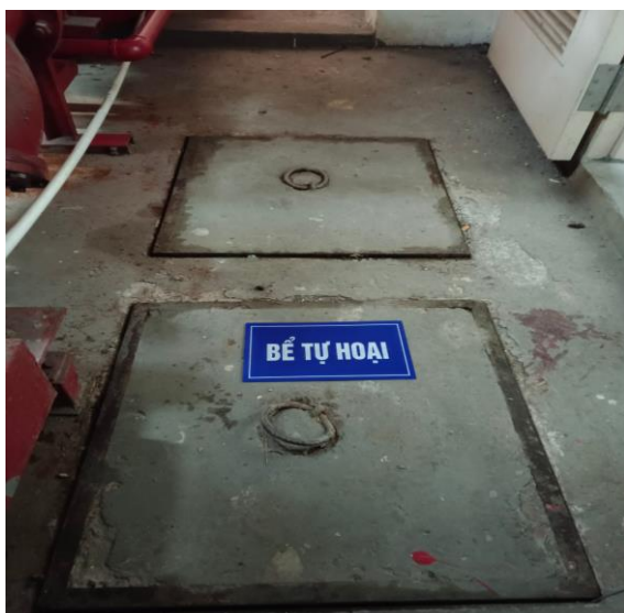
Bể tự hoại
