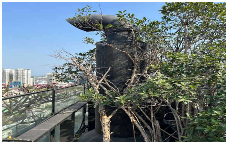
Hình 12: Hình ảnh máy phát điện dự phòng + ống phát thải tầng mái
