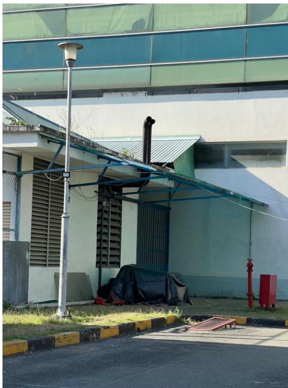
Hình 4. 3: 02 ống khói máy phát điện hiện hữu (sử dụng lại cho máy phát điện mới)
