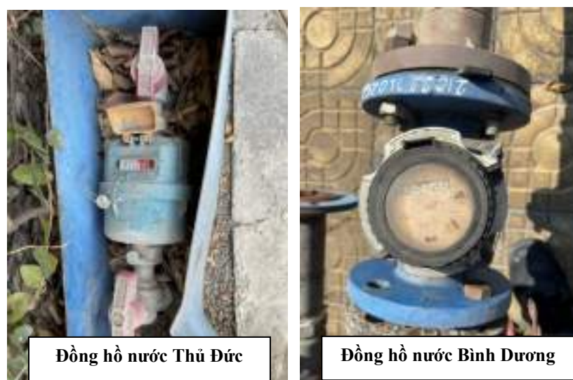
Hình 1.10: Đồng hồ nước cấp của Cơ sở
