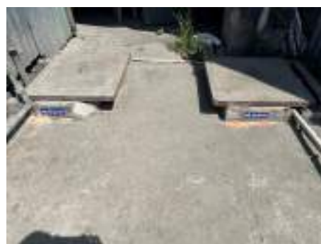
Bể chứa nước thải sinh hoạt và nước thải sản xuất
