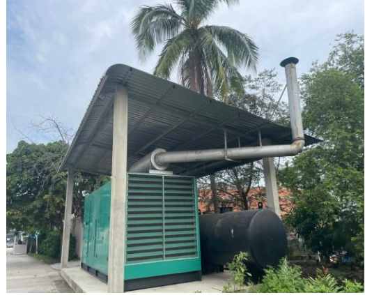
Hình PL2. Máy phát điện
