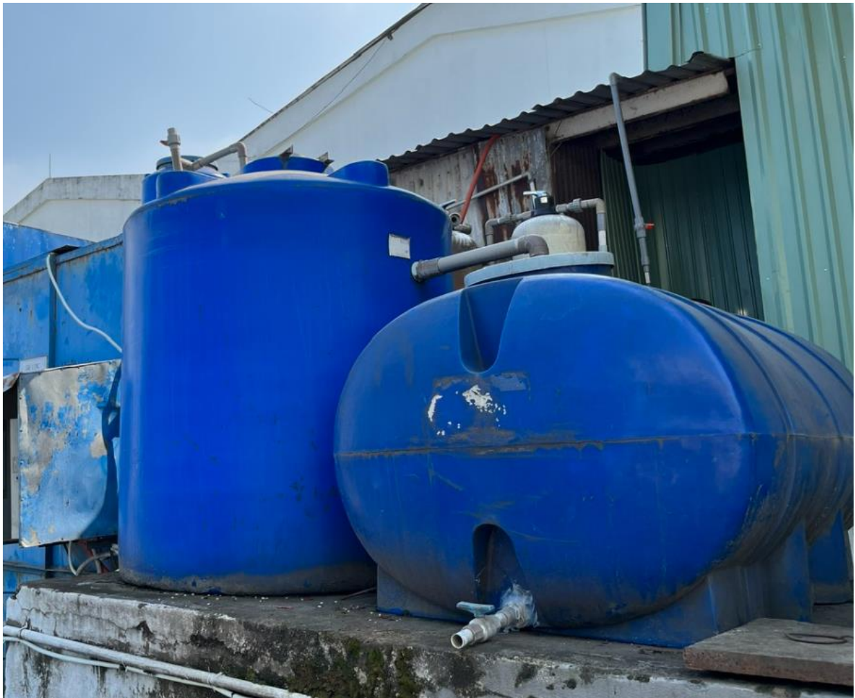
Hình 3.6. Hình ảnh hệ thống xử lý nước thải sinh hoạt
