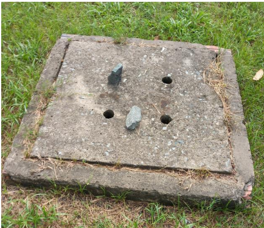
Hình 3.1. Hình ảnh hố ga thoát nước mưa
