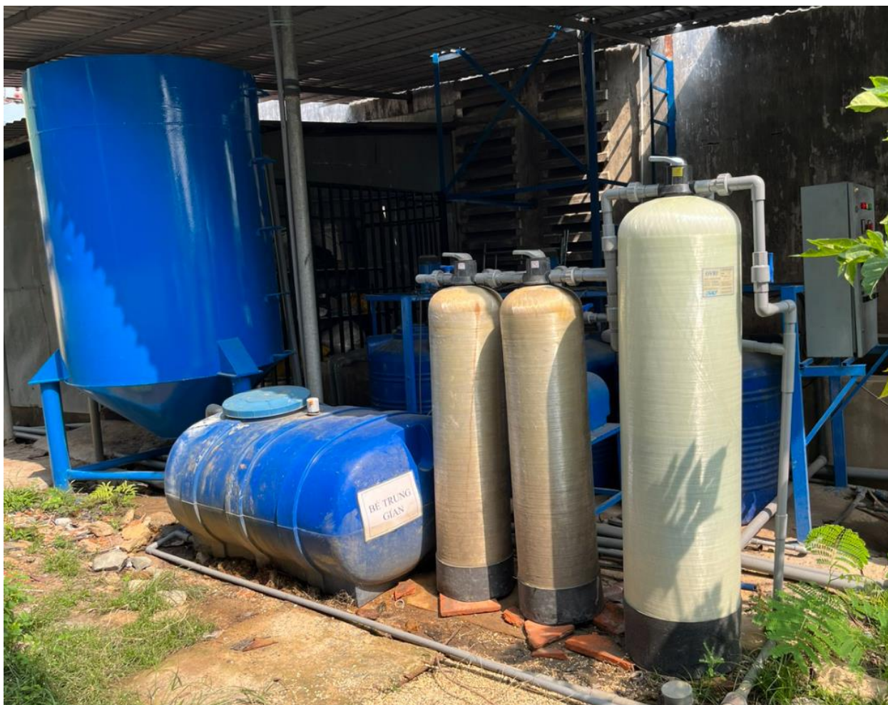
Hình 3.8. Hình ảnh hệ thống xử lý nước thải sản xuất
