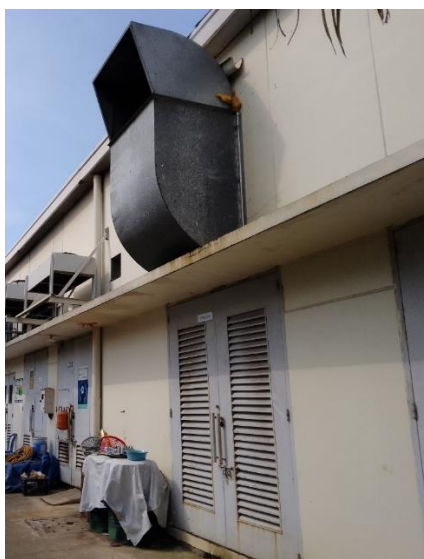
Hình 3. 6. Vị trí máy phát điện của cơ sở
