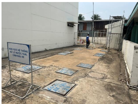
Khu vực hệ thống xử lý nước thải
