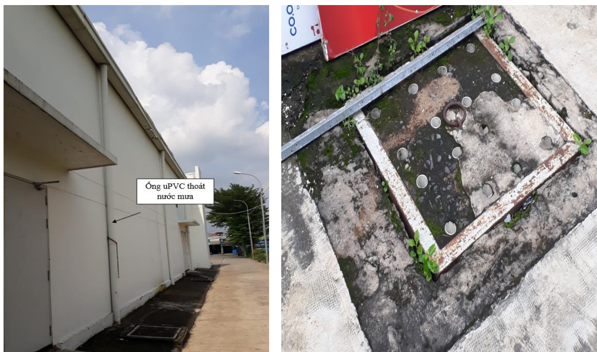
Hình 3. 1. ống đứng thoát nước mưa mái, hố ga thu gom nước mưa chảy tràn
