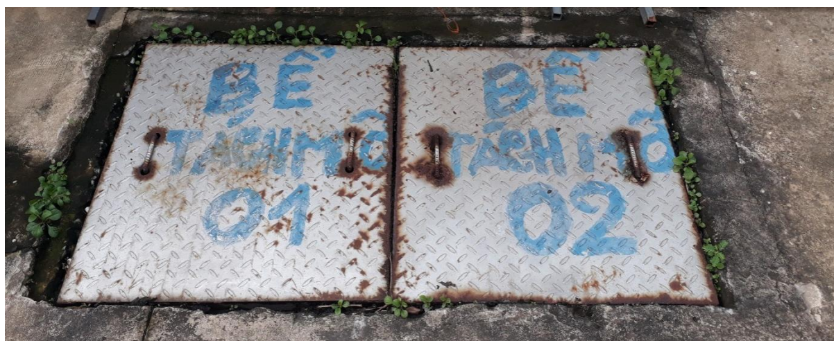
Hình 3. 3. Bể tách mỡ 2 ngăn tại cơ sở
