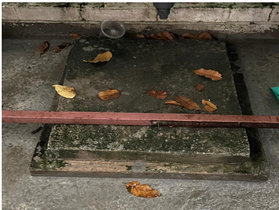
Hình 4. 5: Hố ga sau HTXL nước thải tập trung
