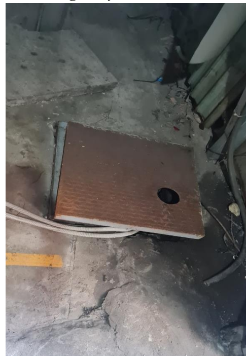
Hố ga giám sát nước thải (hố ga cuối)
