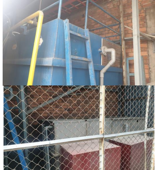
Hệ thống xử lý nước thải cục bộ
