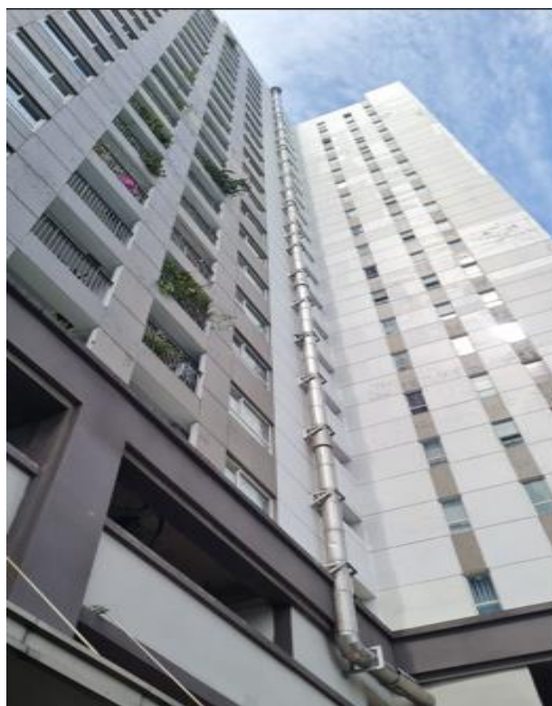
Hình 3.6: Ống thoát khí thải máy phát điện dự phòng
