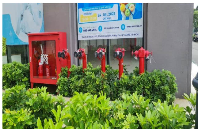
Hình 3.11: Hệ thống chữa cháy
