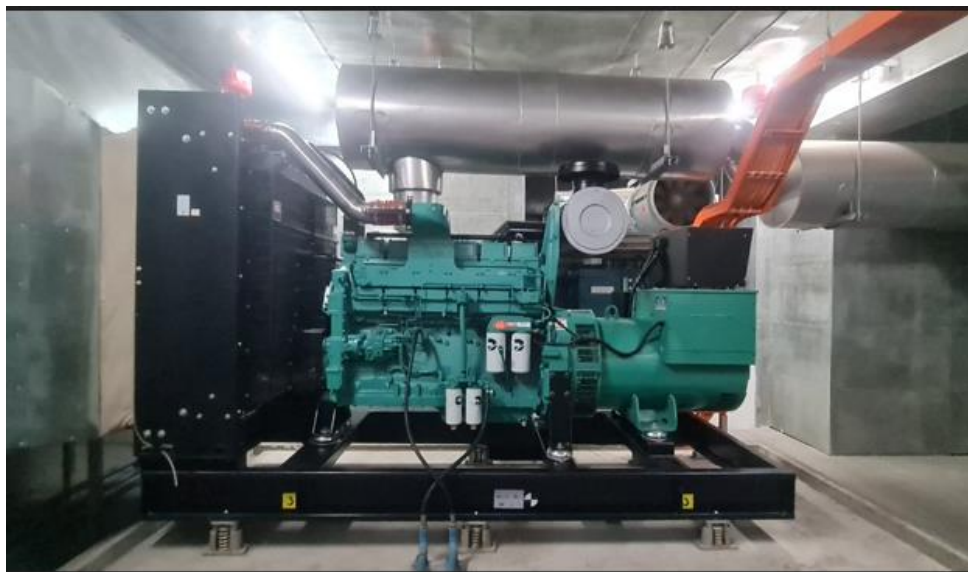
Hình 3.5: Máy phát điện dự phòng
