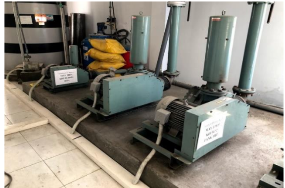
Khu vực đặt máy thổi khí và hóa chất vận hành
