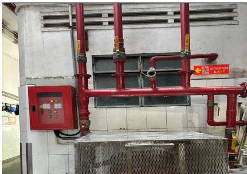
Hình 17. Hệ thống PCCC của bệnh viện
