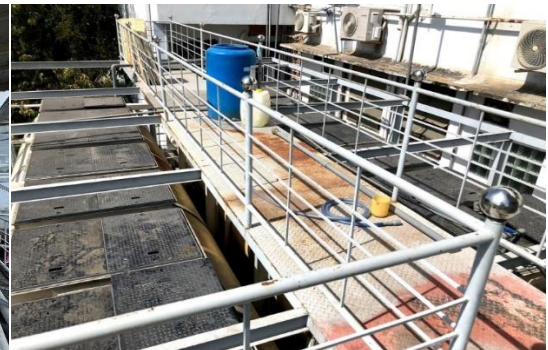
Nắp bể xử lý trên 02 bồn màng MBR
