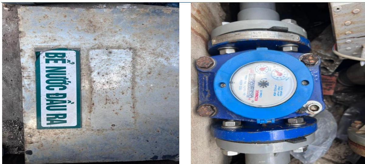
Hình 3.4: Một số hình ảnh về hệ thống xử lý nước thải hiện hữu
