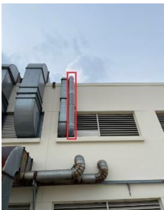
Ống thoát khí thải (mùi) từ hệ thống xử lý nước thải công suất 600 m 3 /ngày đêm
