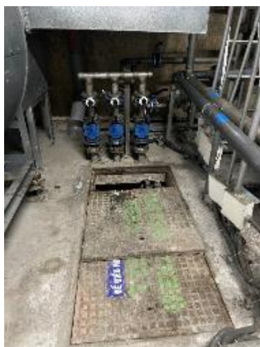
Bể điều hòa
