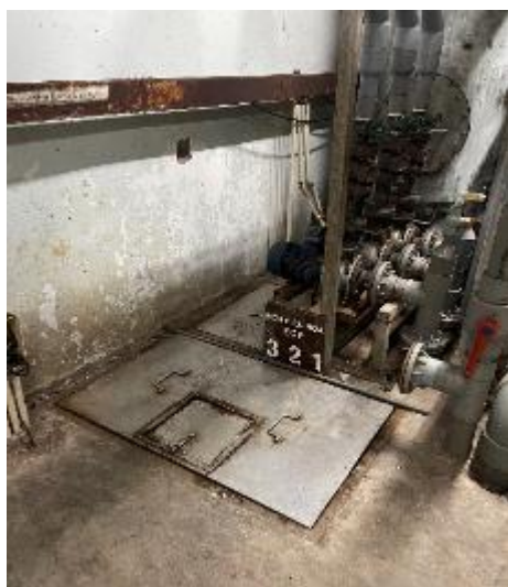
Bể điều hòa
