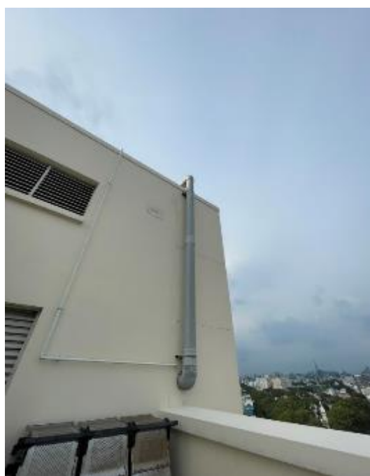
Ống thoát khí thải (mùi) từ hệ thống xử lý nước thải công suất 220 m 3 /ngày đêm
