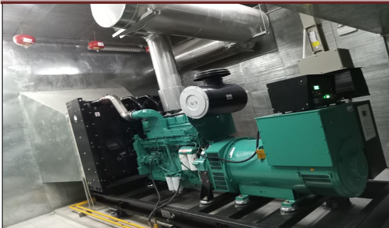
Hình 16. Hệ thống cách âm tiếng ồn từ máy phát điện công suất 650KVA tại Khối C, D
