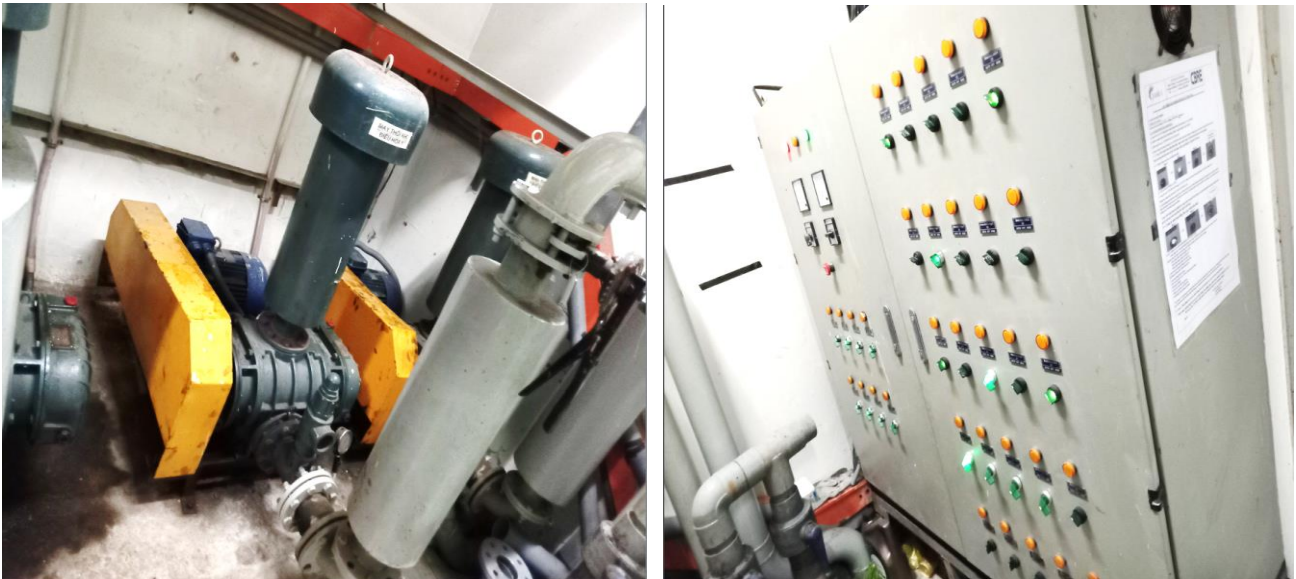
Hình 17. Máy móc thiết bị trong nhà điều hành được xây trong phòng kín
