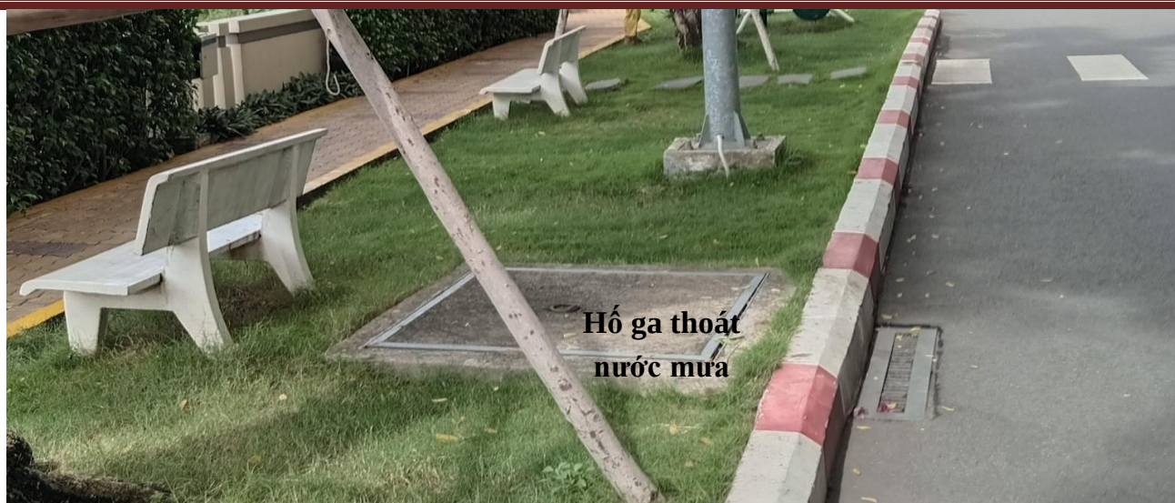
Hình 5. Hệ thống thoát nước mưa và Cửa xả nước mưa ra Rạch Bà Hiện
