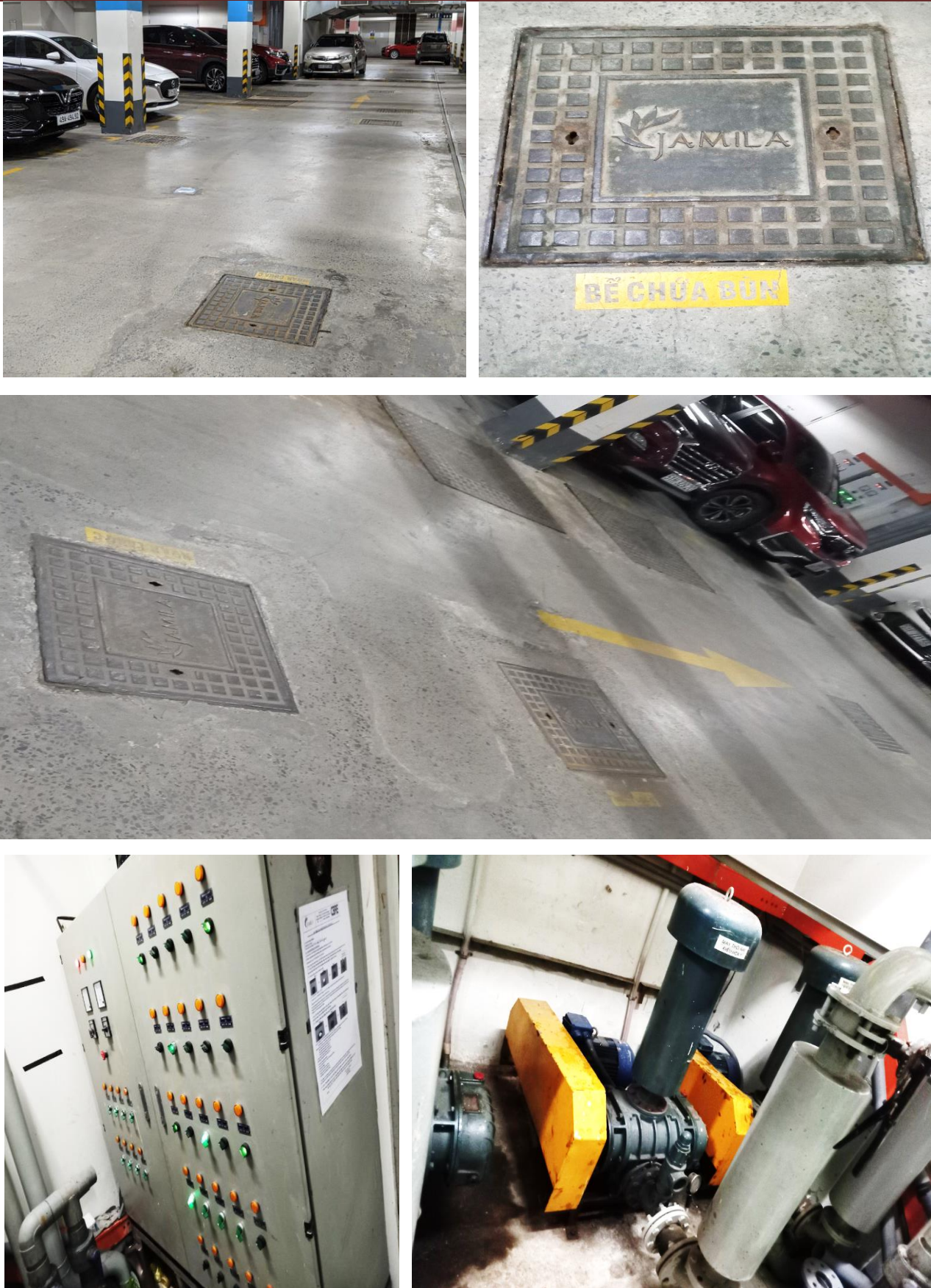
Hình 8. Hình ảnh thực tế Trạm xử lý nước thải tại cơ sở
