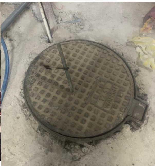
Hình 6. Hồ ga thu gom nước mưa tại tầng hầm B3
