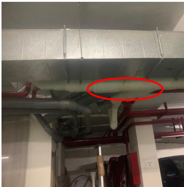
Hình 5. Hệ thống đường ống dẫn nước mưa từ các tầng thoát ra cống chung
