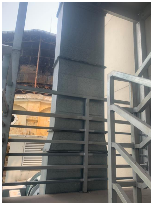
Hình 14. Hệ thống hút mùi tại nhà Bếp tầng 1
