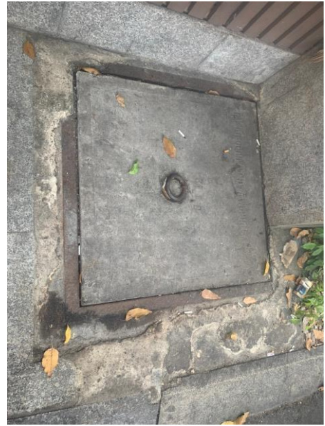
Hình 8. Hố ga đầu nối vào hệ thống cống chung của thành phố
