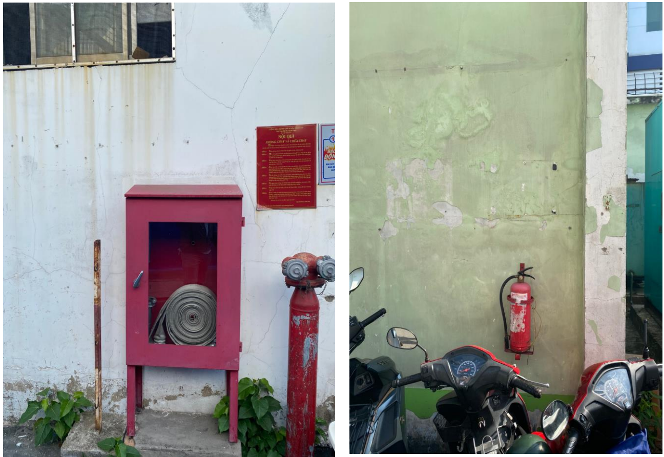
Hình 13: Hộp PCCC + Lăng phun nước + trụ tiếp nước + Bình chữa cháy CO 2 được bố trí bên trong và bên ngoài của Siêu thị
