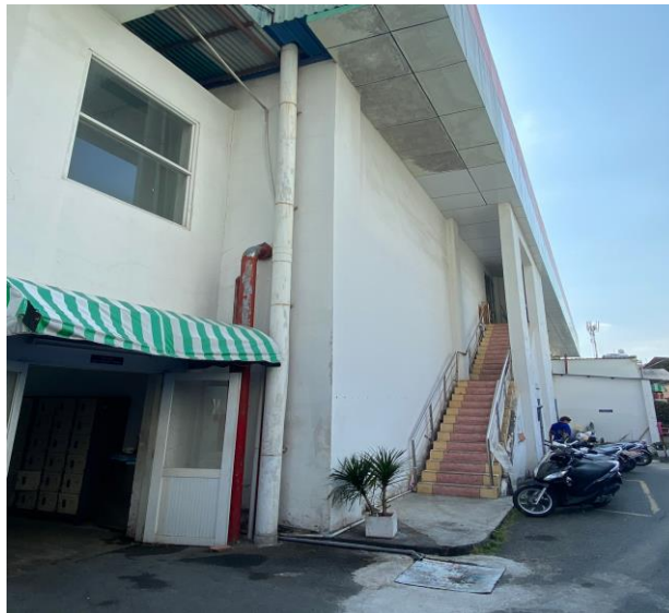
Hình 5: Hình ảnh các tuyến ống thu đứng nước mưa từ mái nhà xuống hồ ga thu nước mưa tập trung của Siêu thị
