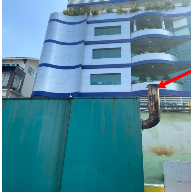
Hình 15: Ống thoát khí thải máy phát điện dự phòng, công suất 750 kVA của Siêu thị
