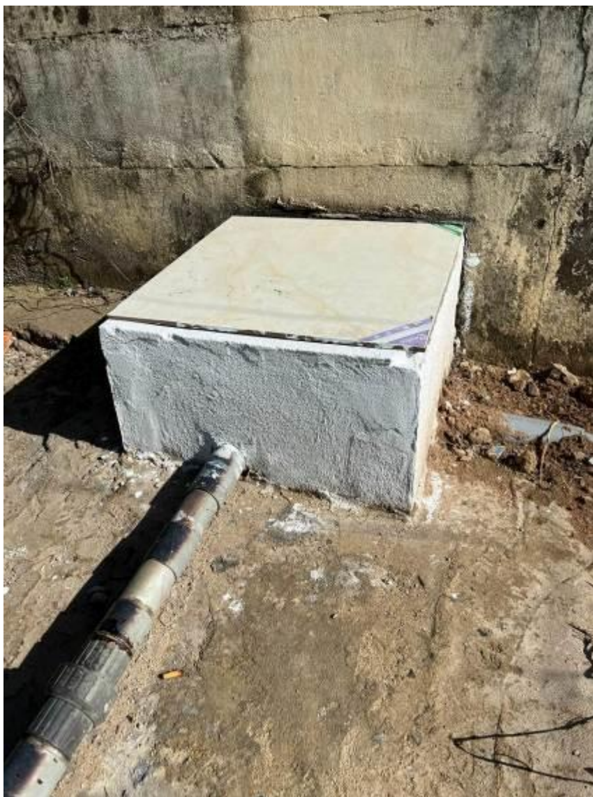
Hình 3.4. Hồ ga thoát nước thải của cơ sở
