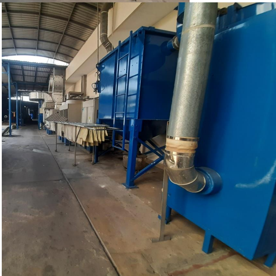
Hình 3.10: Khu vực hệ thống lọc bụi, khí thải tại các công đoạn trộn
