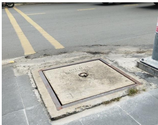
Hình 4. Hồ ga thoát nước giáp Công ty Waseco (GTN1)
