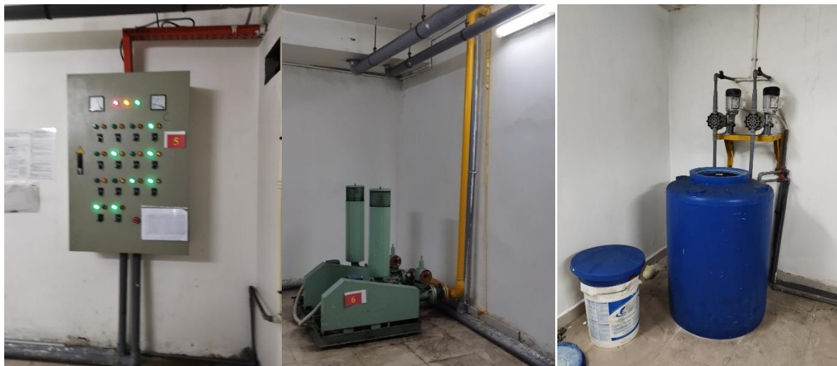
Hình 13. Hệ thống xử lý tại Block C
