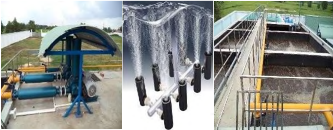
Hình 3.7: Bể bùn hoạt tính Aerotank
