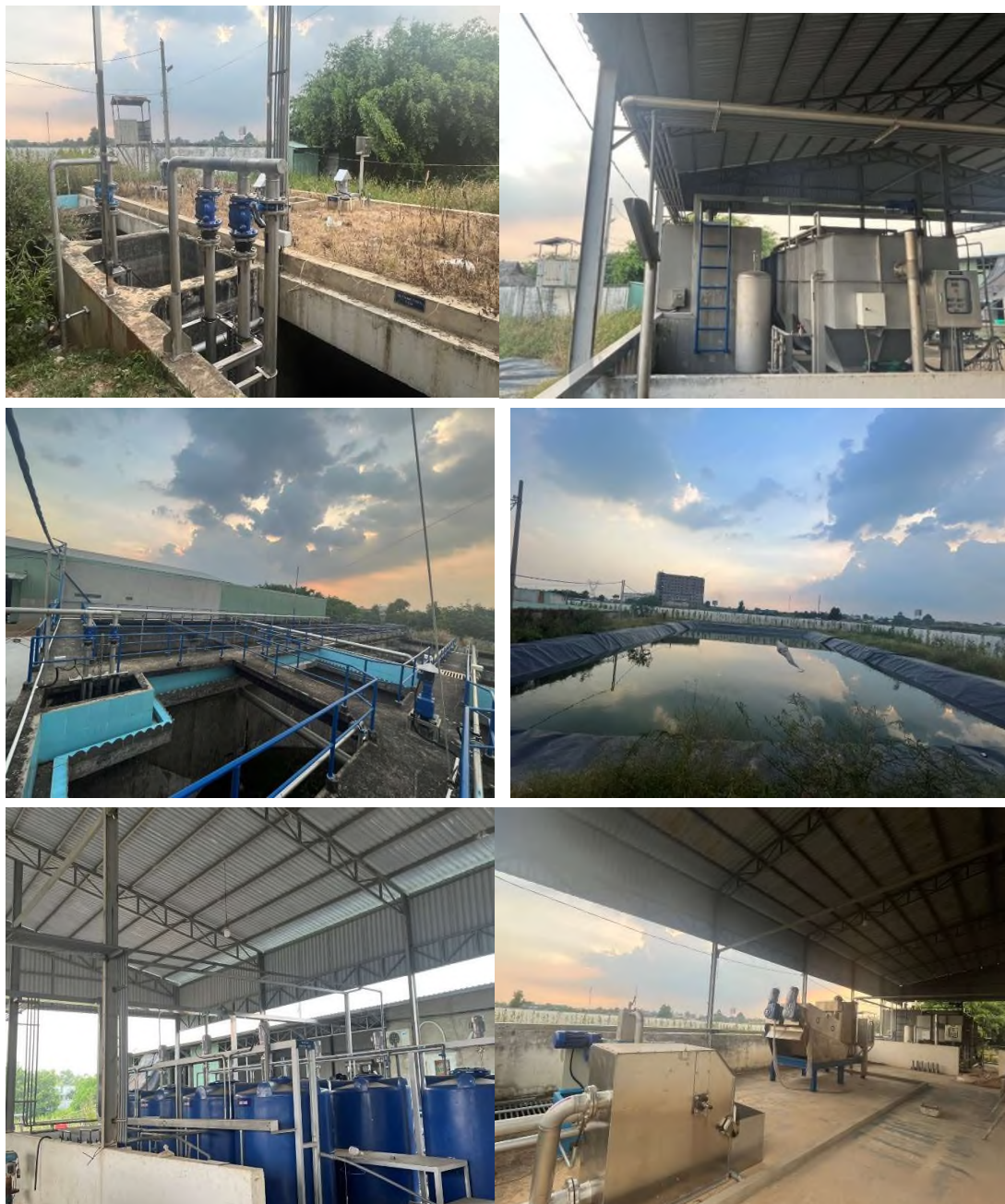
Hình 3.9: Một số hình ảnh của hệ thống xử lý nước thải
