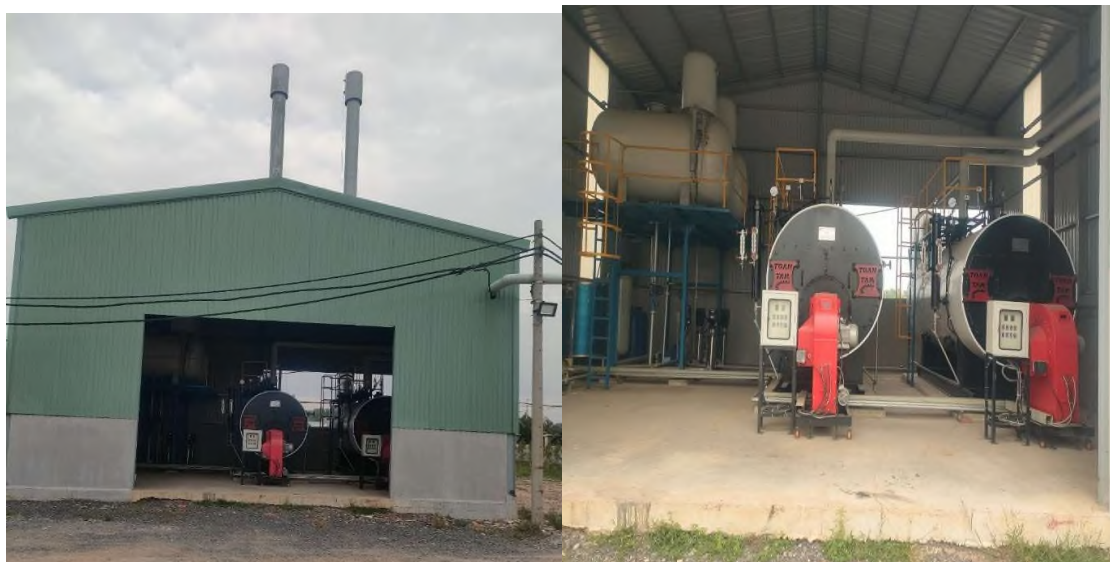
Hình 3.12: Khu vực lò hơi
