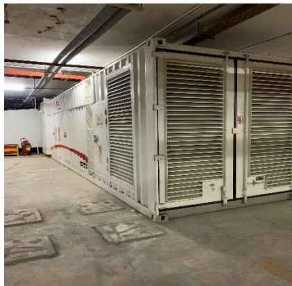
Hình 3.8. Máy phát điện dự phòng
