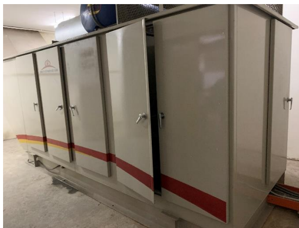
Hình 1.3. Máy phát điện Chung cư Era Town
