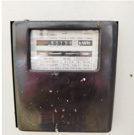
Hình 3.7. Hình ảnh công tơ điện Hệ thống XLNT chung cư Era Town
