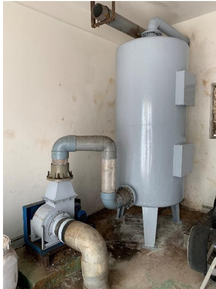
Hình 3.11. Hệ thống xử lý mùi của trạm xử lý nước thải
