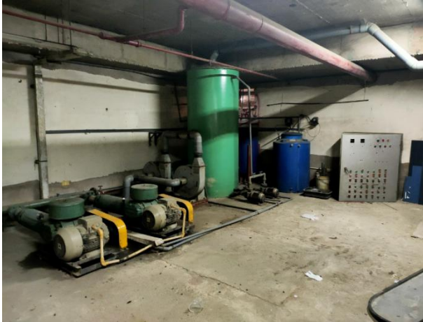
Thiết bị, bồn chứa hóa chất của trạm 300 m 3 /ngày – Khu C
