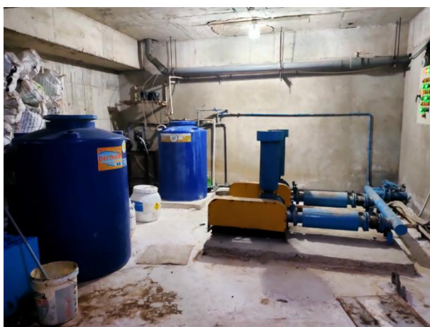
Thiết bị, bồn chứa hóa chất của trạm 400 m 3 /ngày – Khu C
