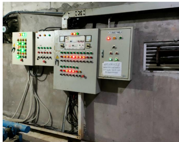
Tủ điều khiển và thiết bị của trạm 400 m 3 /ngày – Khu AB
