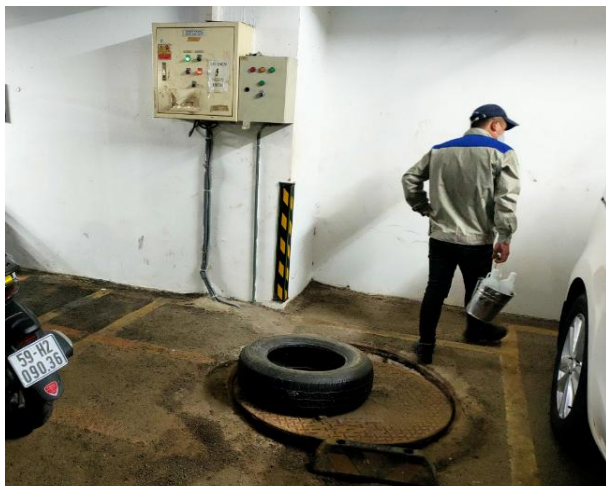
Tủ điện Bơm nước thải đầu ra
