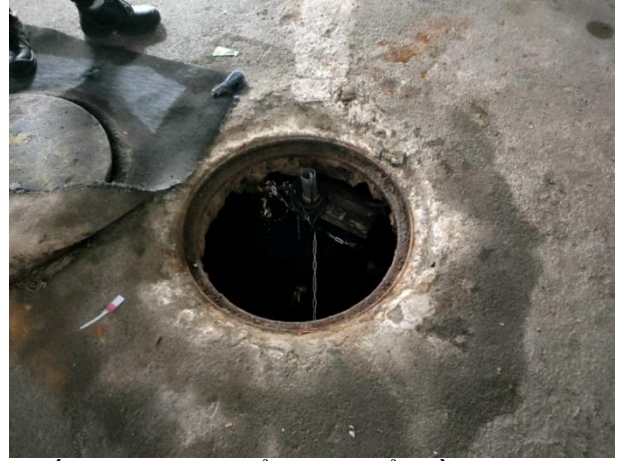
Nắp thăm tiêu biểu tại 1 bể điều hòa của trạm 300 m 3 /ngày – Khu C
