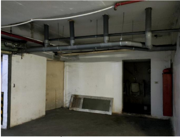
Đường ống thu gom nước thải
