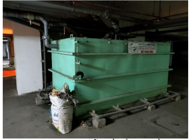
Nước thải được dẫn về bể tách dầu
