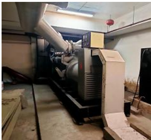
Hình ảnh máy phát điện dưới tầng hầm
