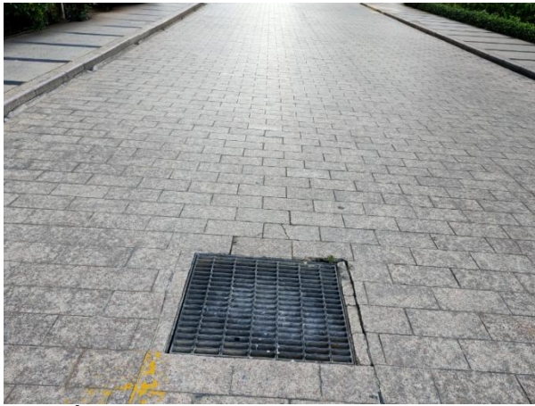
Hệ thống thoát nước mưa xung quanh cơ sở
