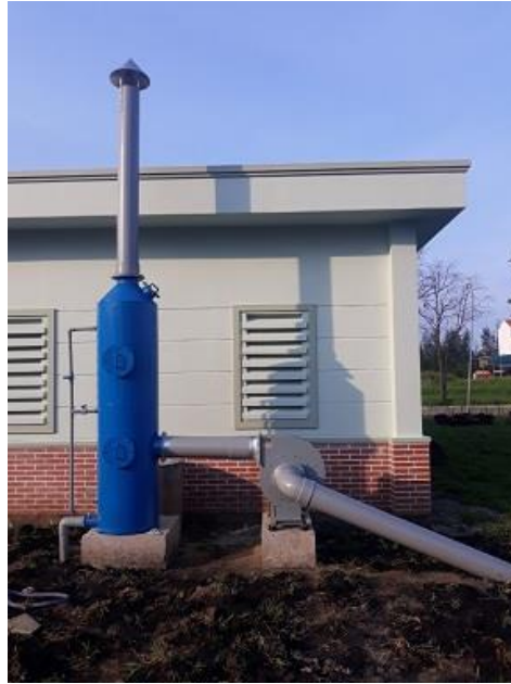
Hình 3. 6: Hình ảnh hệ thống khử mùi của trạm XLNT
