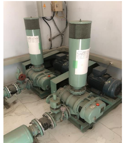
Thiết bị tại hệ thống xử lý
