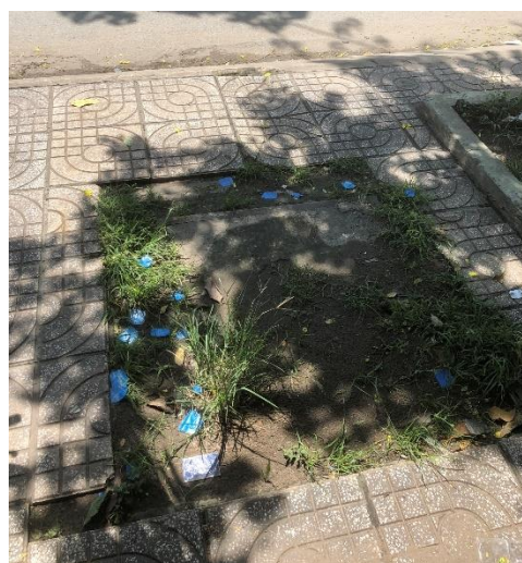
Hố ga đầu nổi nước mưa
