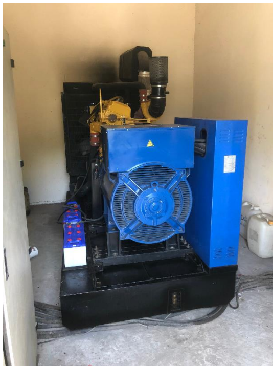
Máy phát điện 450 KVA
