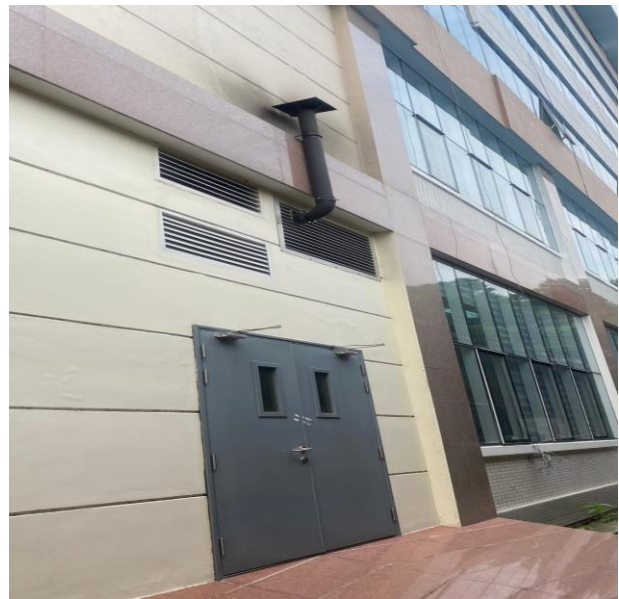
Ổng thải máy phát điện 250 kVA ở Tòa nhà F1
