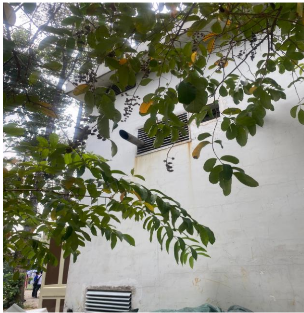
Ổng thải máy phát điện 300 kVA ở gần Tòa Nhà Trung Tâm
