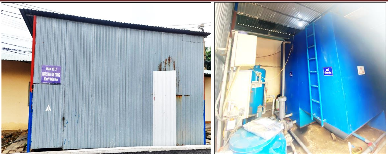
Hình 19. Hiện trạng hệ thống XLNT tập trung của cảng
