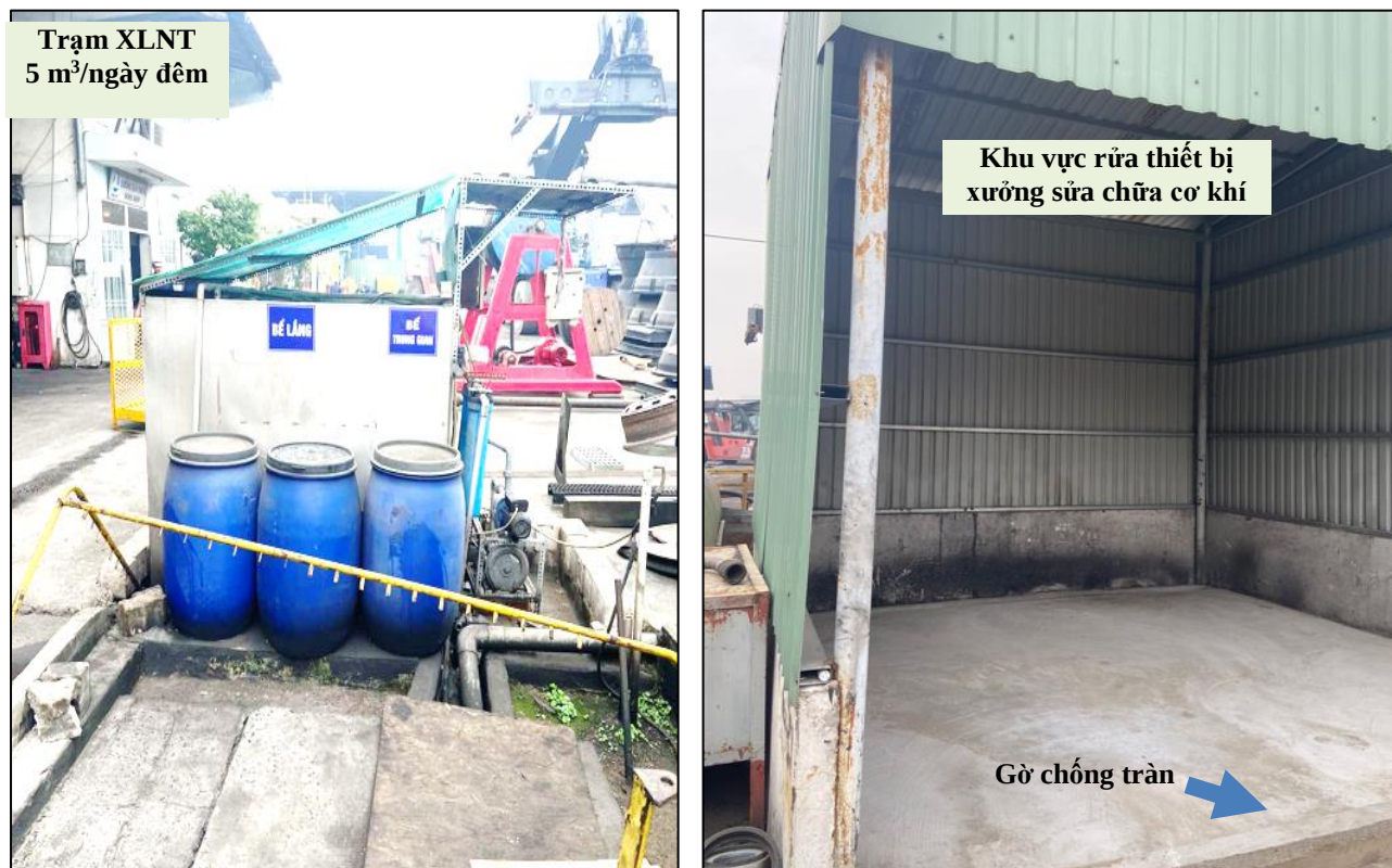
Hình 20. Hệ thống xử lý nước thải xưởng sửa chữa cơ khí công suất 5 m 3 /ngày.đêm
