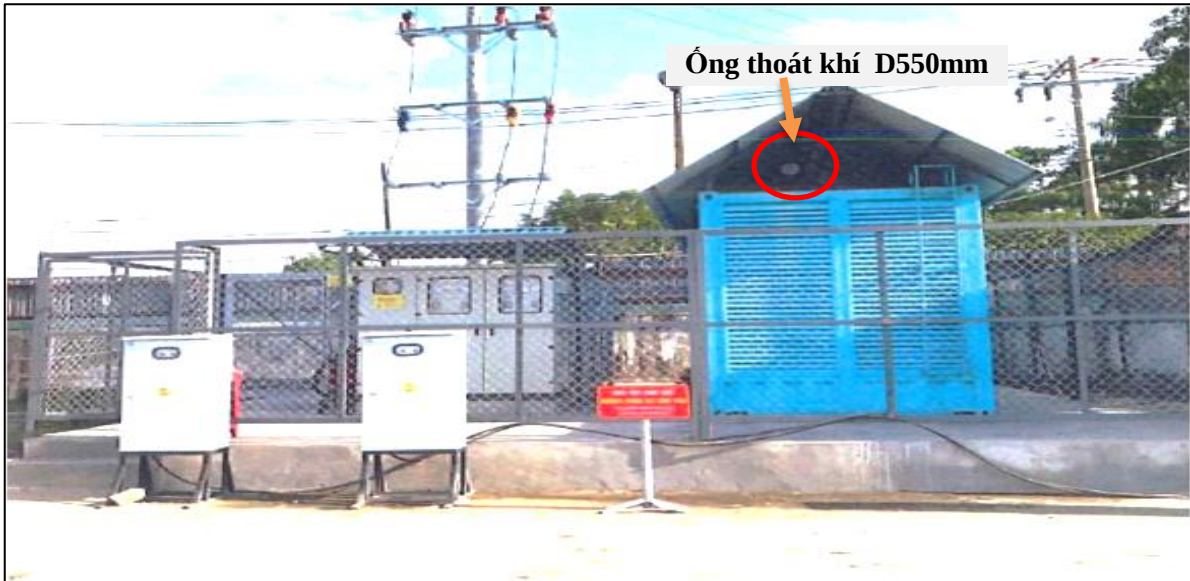
Hình 22. Hình ảnh ống thoát khí thải máy phát điện dự phòng công suất 550KVA
