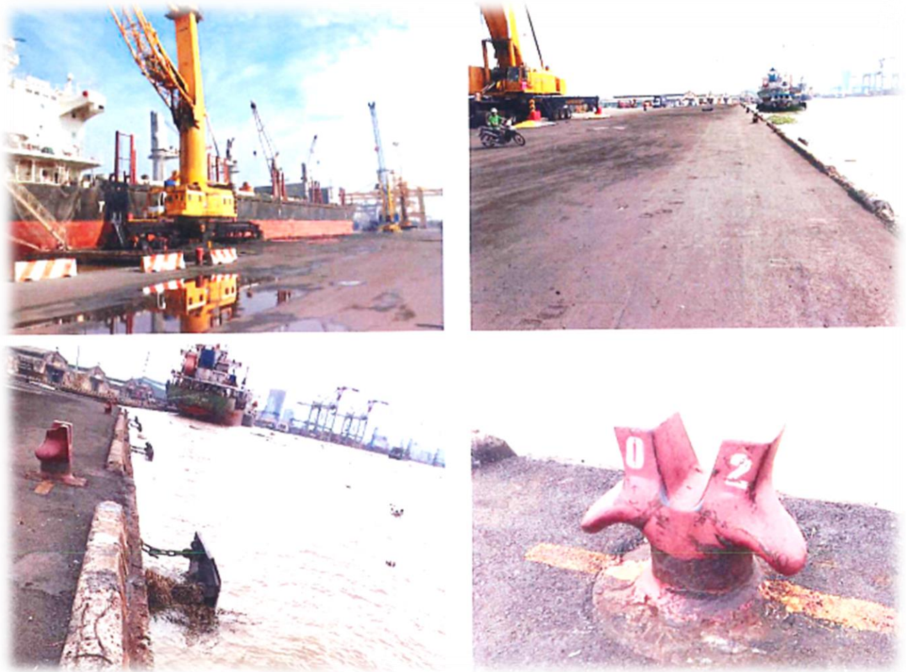
Hình 4. Hiện trạng công trình cầu cảng K15B
