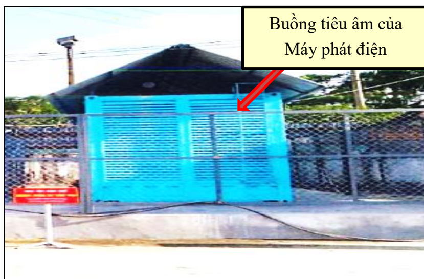
Hình 27. Hình ảnh buồng tiêu âm máy phát điện
