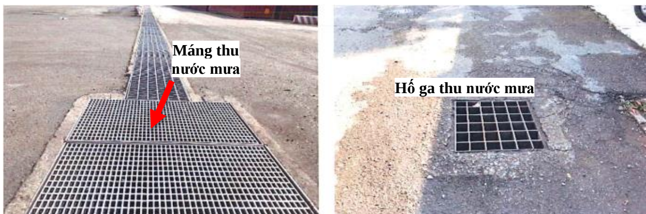
Hình 12. Hệ thống thu gom nước mưa tại cơ sở
