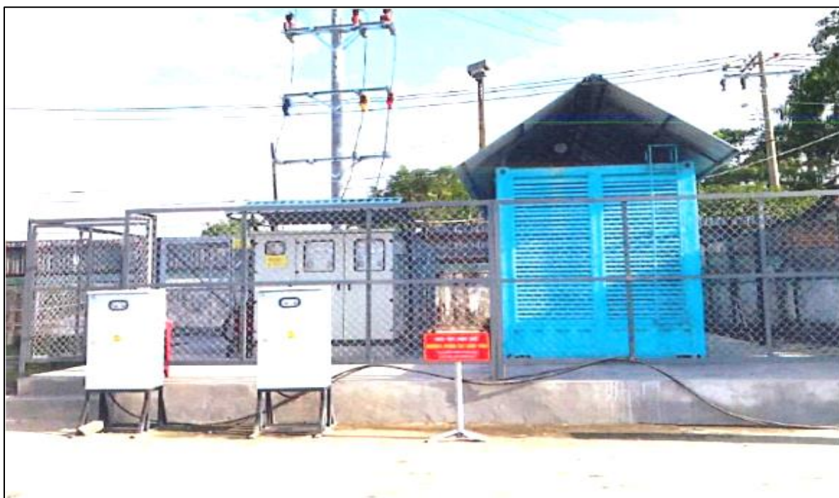
Hình 9. Hiện trạng trạm điện và phát điện dự phòng công suất 550KVA
