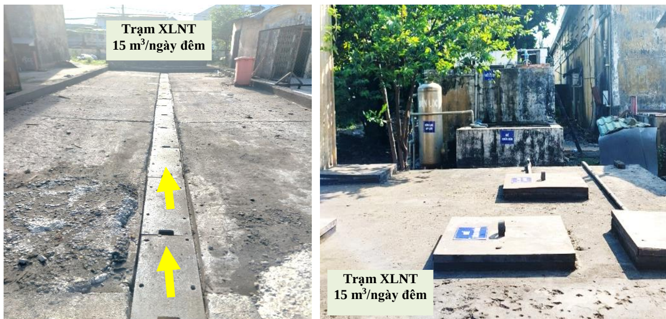
Hình 18. Hiện trạng hệ thống xử lý nước thải bãi rửa xe, container công suất 15 m 3 /ngày đêm
