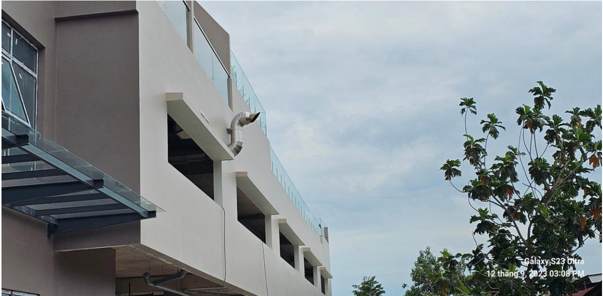
Hình 3.8: Ống thoát khí thải của máy phát điện
