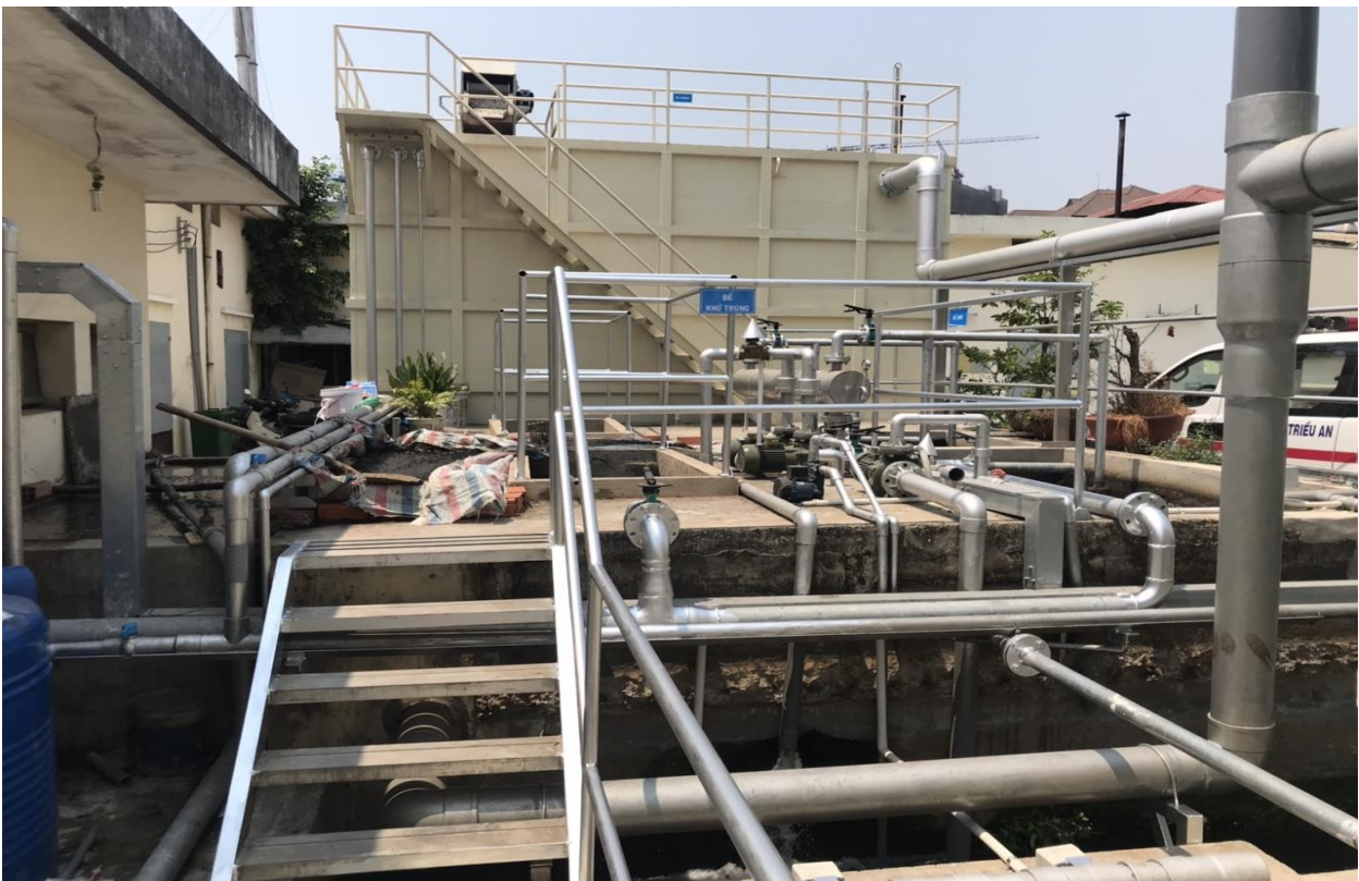
Hình 3.9. Bể Khử trùng
