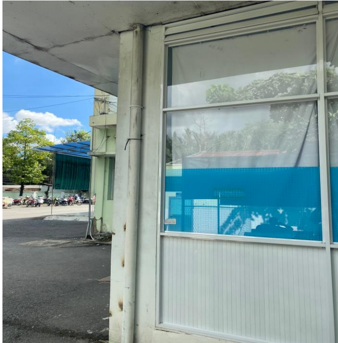
Các tuyến ống thu đứng nước mưa từ mái nhà xuống hố ga thu nước mưa tập trung của Bệnh viện
