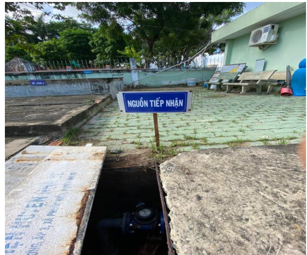
Hố ga đầu nối nước thải sau xử lý
