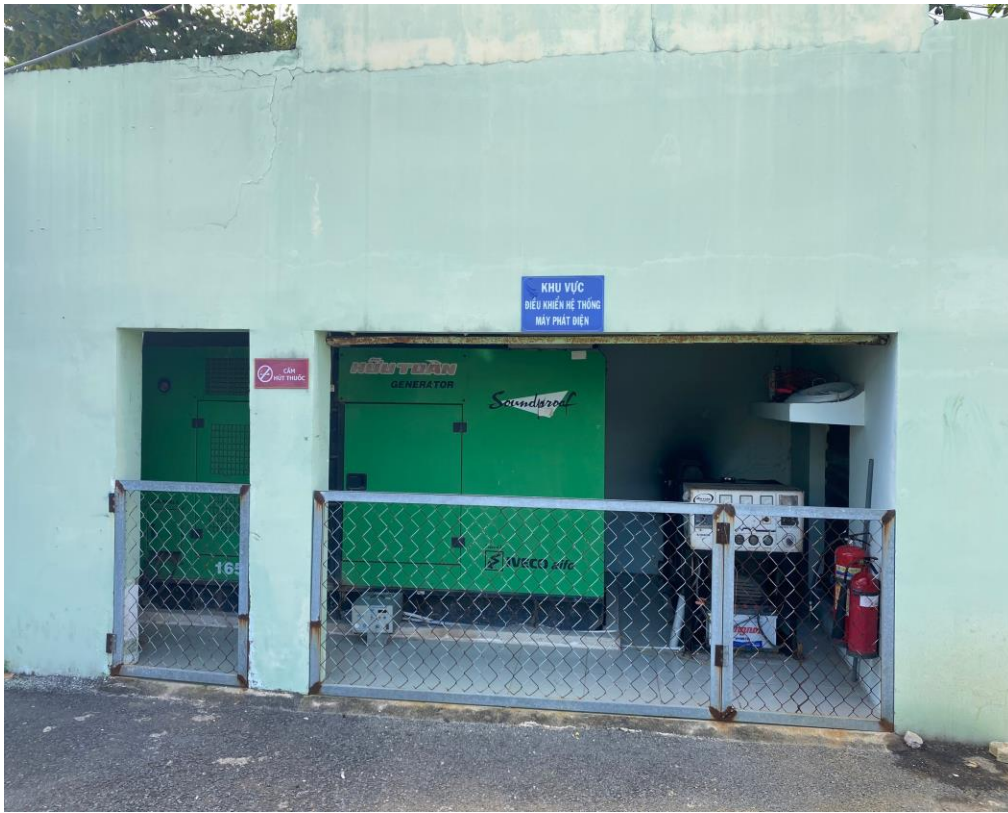
Hình ảnh nhà đặt máy phát điện của Bệnh viện
