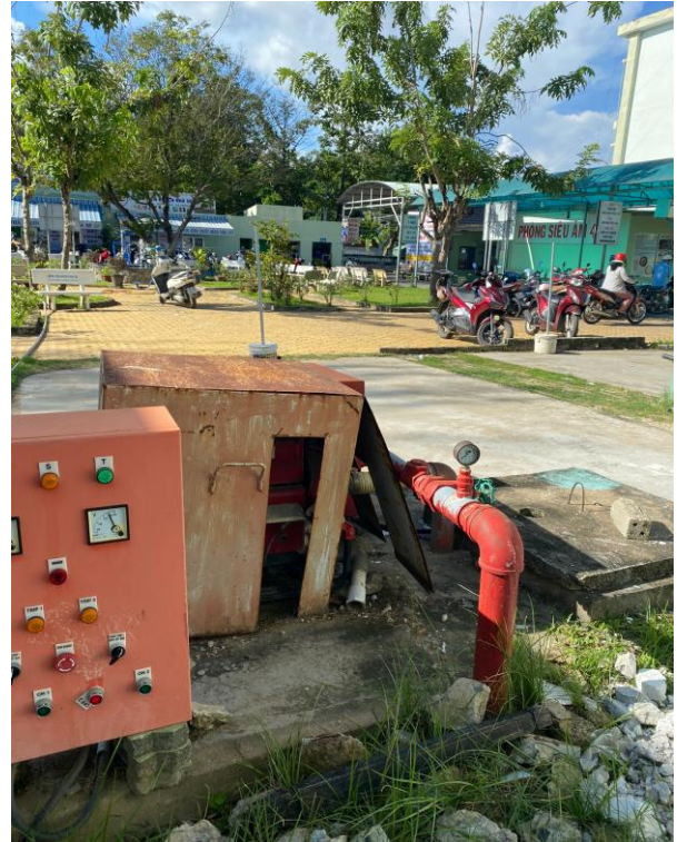
Bể nước PCCC 60 m 3
