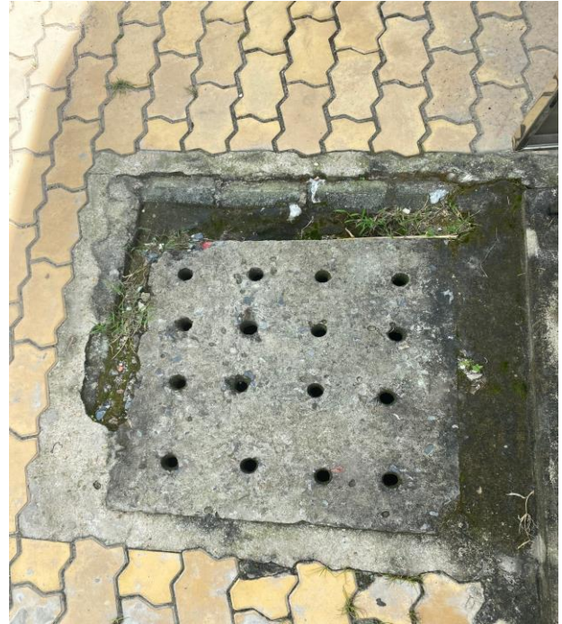
Nước mưa chảy tràn trên mặt đường giao thông nội bộ, sân,..., được thu bằng các hố ga thu nước có kích thước 1m x 1m, lỗ tròn thu nước đường kính 5cm
