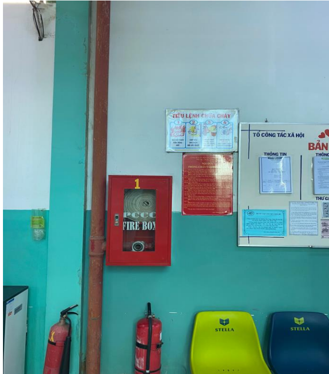
Hộp PCCC + Lăng phun nước + Bình chữa cháy CO 2 được bố trí bên trong các Khu nhà của Bệnh viện và bên ngoài Bệnh viện
