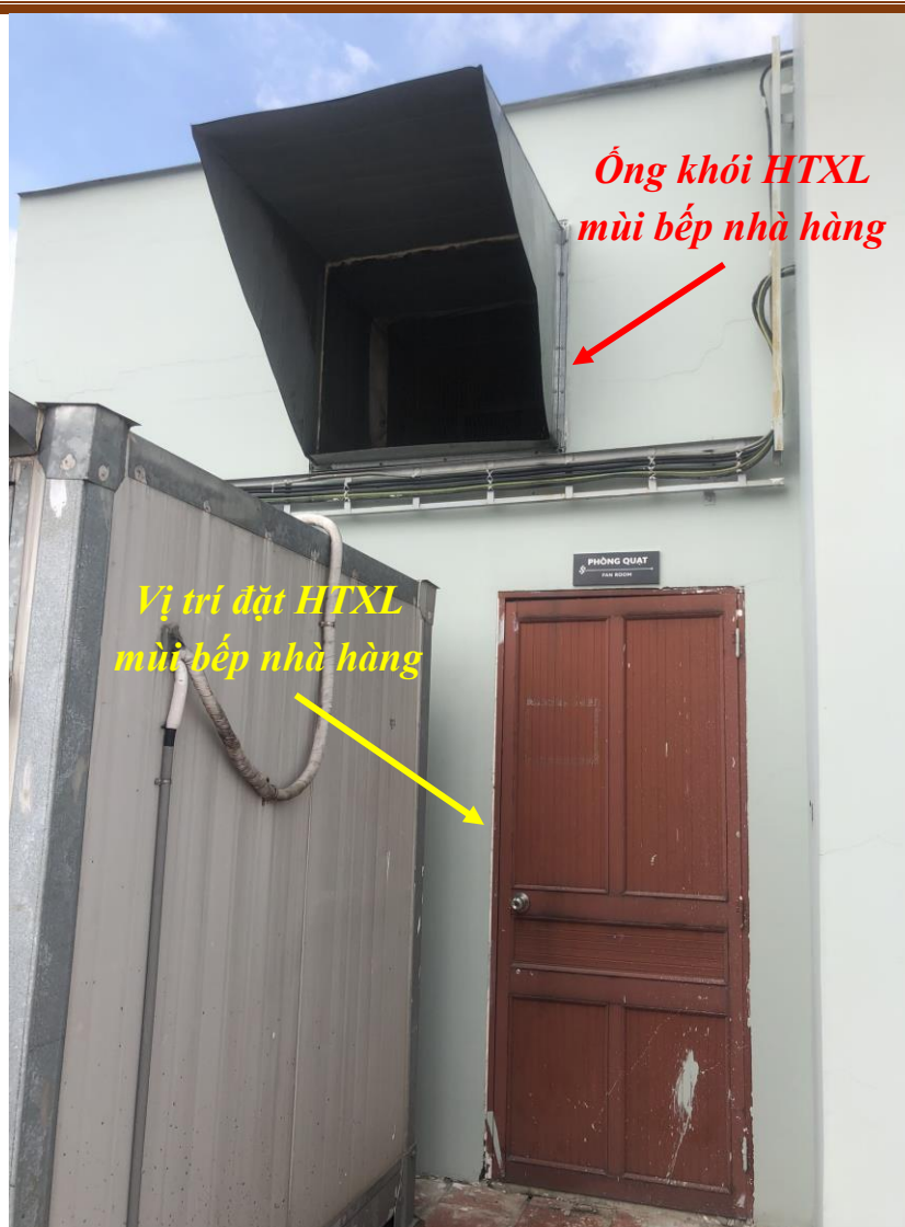
Hình 3. 8. Hình ảnh khu vực đặt hệ thống xử lý mùi bếp nhà hàng và ống thải
