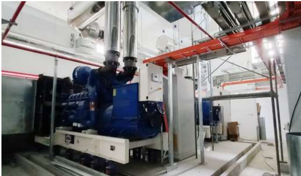
Hình 3.14 Khu vực bố trí máy phát điện
