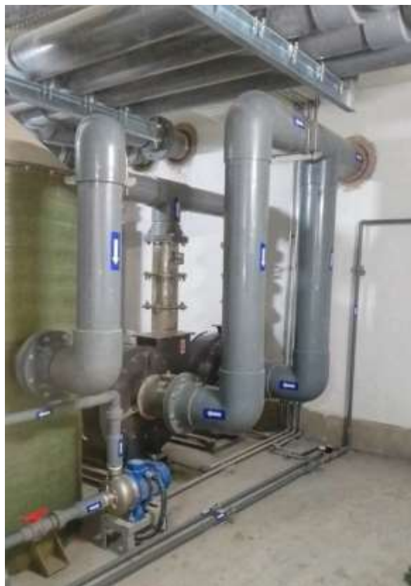
Hình 3.12 Hệ thống khử mùi
