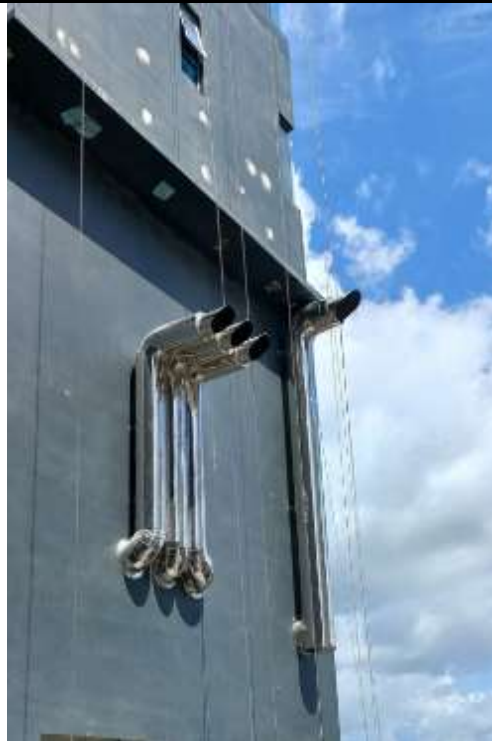
Hình 3.15 Ống khói máy phát điện
