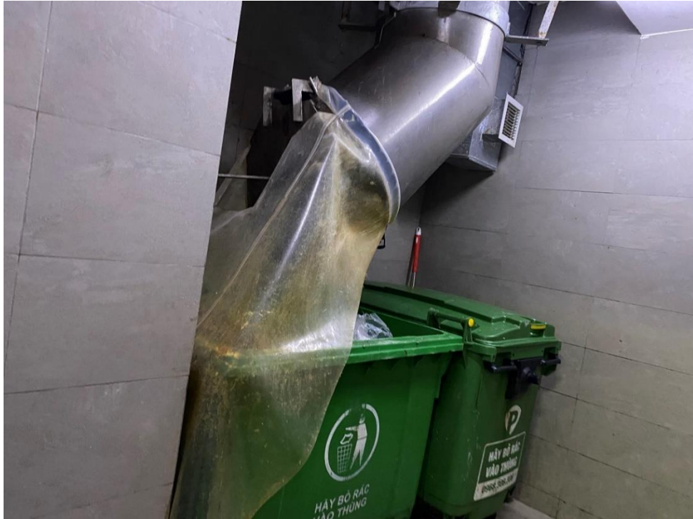
Hình 3. 10 Ống gen thu gom rác tại tầng 1 của Dự án
