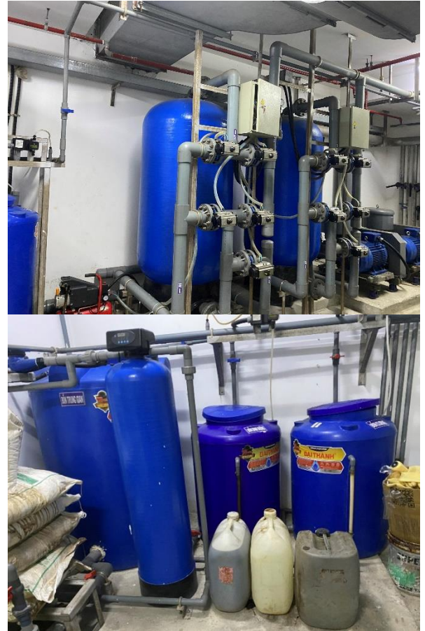
Bồn lắng, bồn trung gian, bồn dinh dưỡng và bồn lọc
