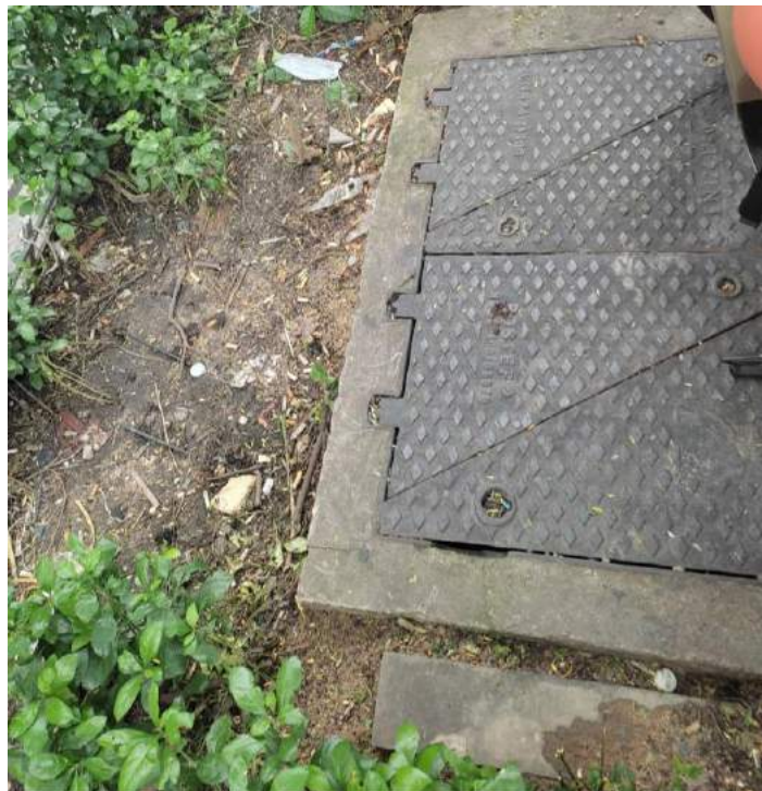
Hình 3. 1: Hố ga thoát nước mưa trên đường Lý Tự Trọng
