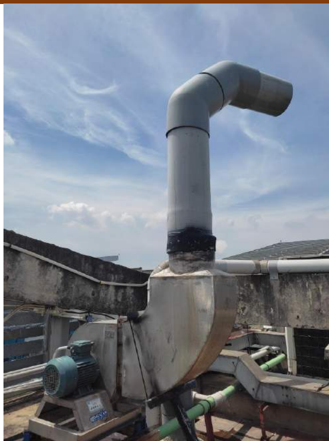
Hình 3. 7. Ống thoát hơi hệ thống xử lý khí thải trạm XLNT
