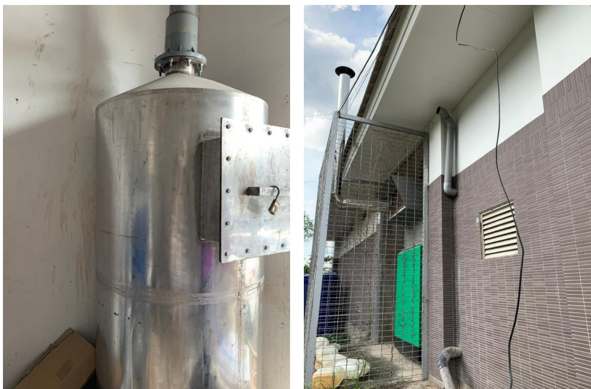
Hình 3.6 Hình ảnh hệ thống xử lý mùi từ hệ thống xử lý nước thải
