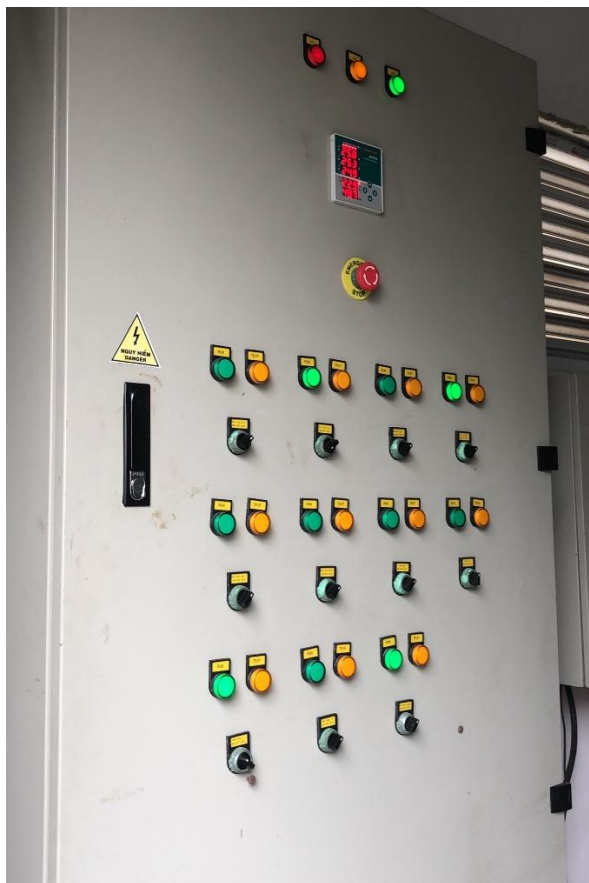
Tủ điều khiển
