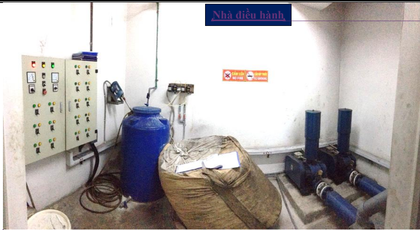
Hình 1144. Hình ảnh thực tế Trạm xử lý nước thải tại dự án
