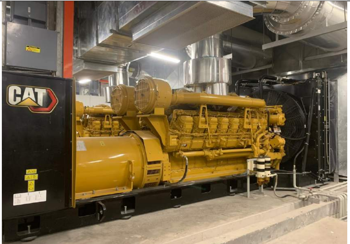
Hình 3. 15. Máy phát điện đặt ở tầng hầm
