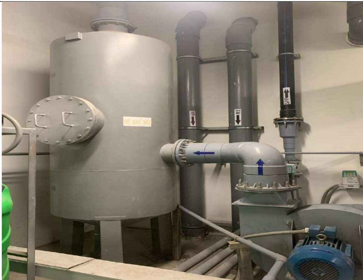
Hình 3. 19. Tháp hấp phụ bằng than hoạt tính đã được lắp đặt
