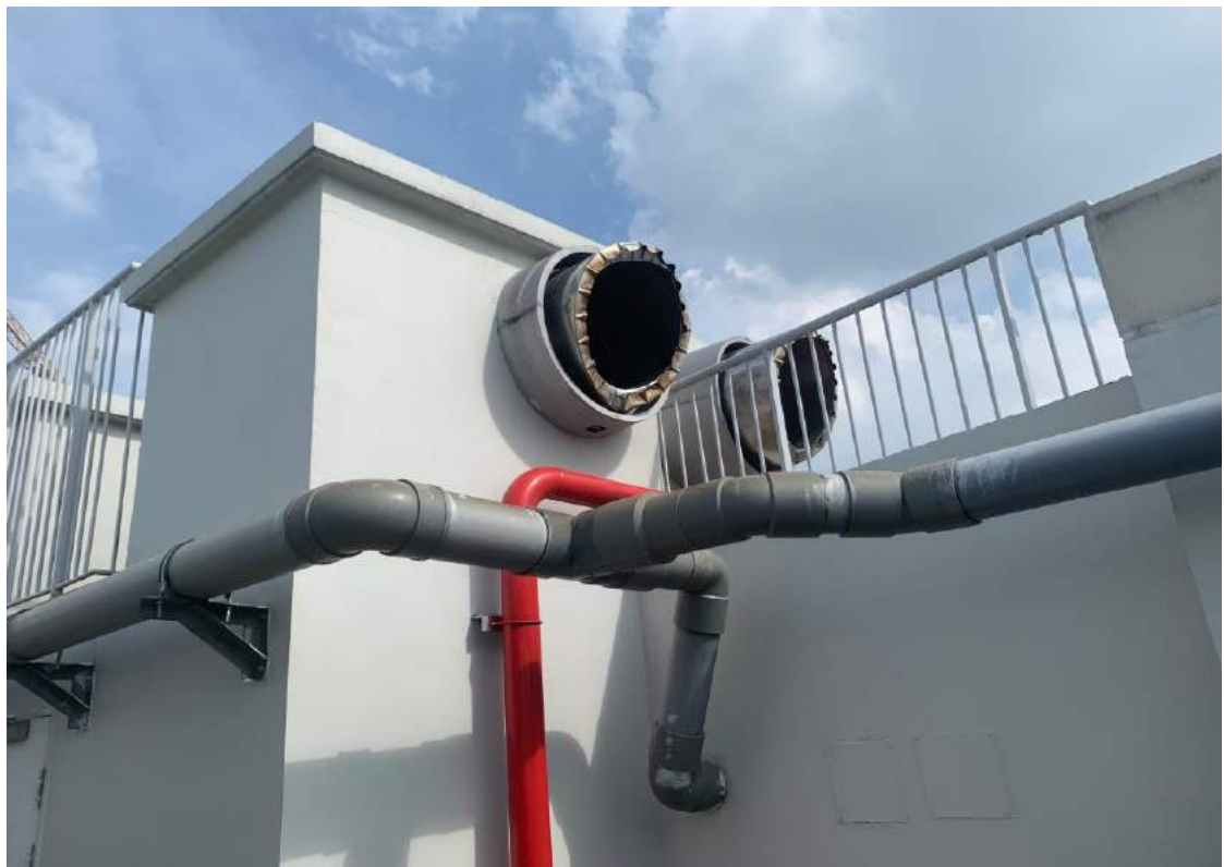
Hình 3. 16. Ống khói máy phát điện đặt ở tầng 12
