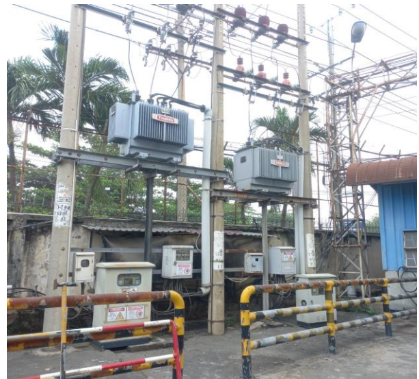
Khu vực trạm điện
