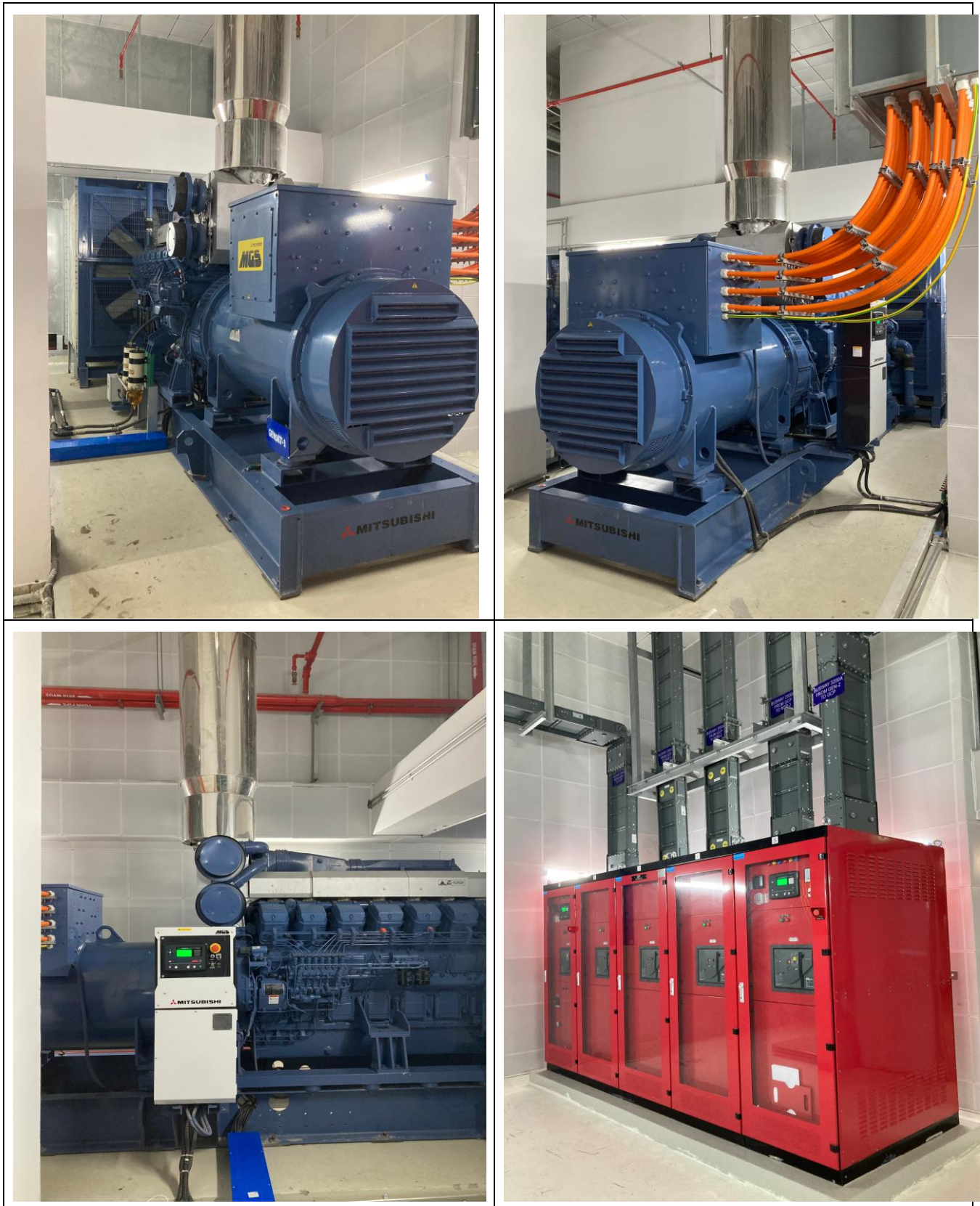
Hình 3.8: Hình ảnh máy phát điện dự phòng
