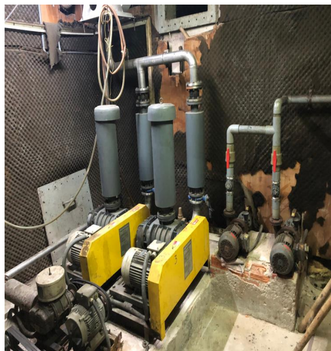
Thiết bị tại hệ thống xử lý
