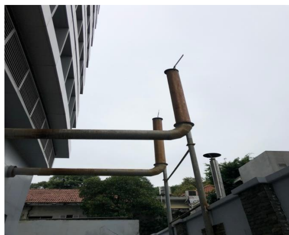
Ống khói máy phát điện
