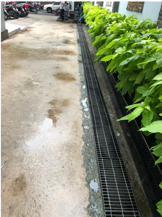
Mương thoát nước mưa
