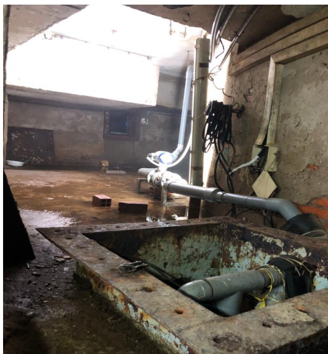
Hệ thống xử lý nước thải
