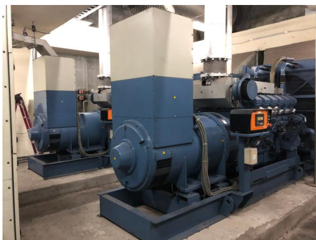
Máy phát điện
