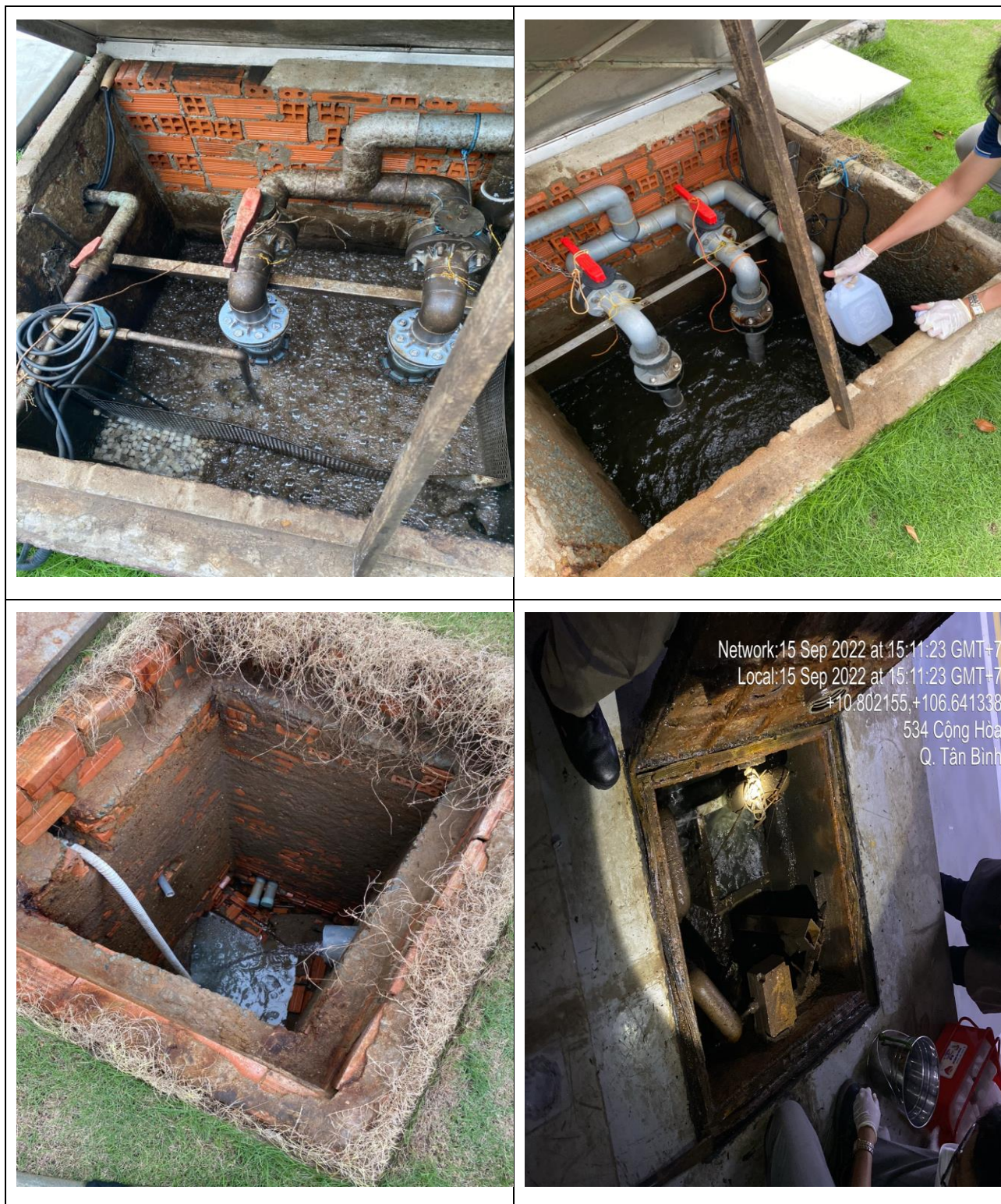
Hình 3.7: Một số hình ảnh về hệ thống xử lý nước thải hiện hữu của các Tòa nhà Etown
