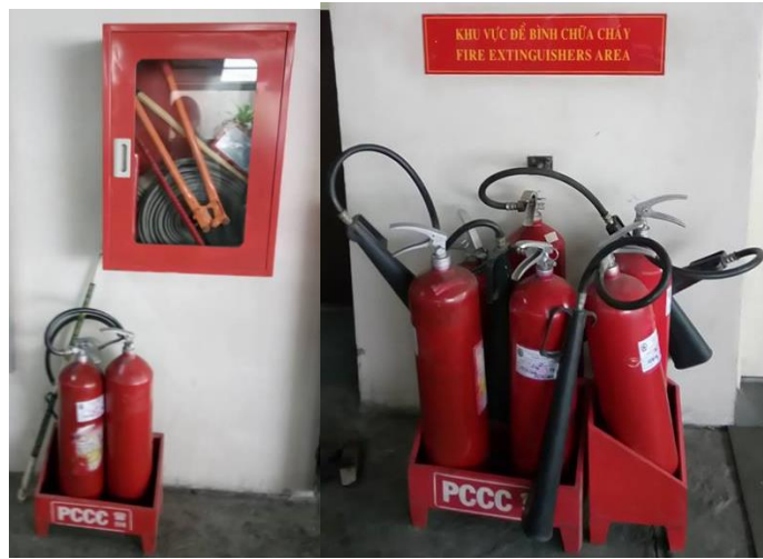
Hình 11. Máy móc, thiết bị PCCC tại Cơ sở
