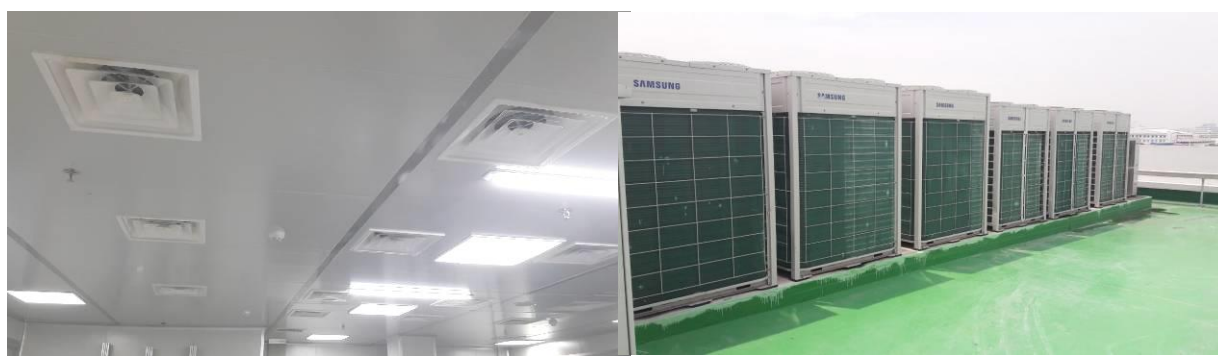
Hình 4.16. Hệ thống điều hòa không khí trung tâm được trang bị tại dự án.
