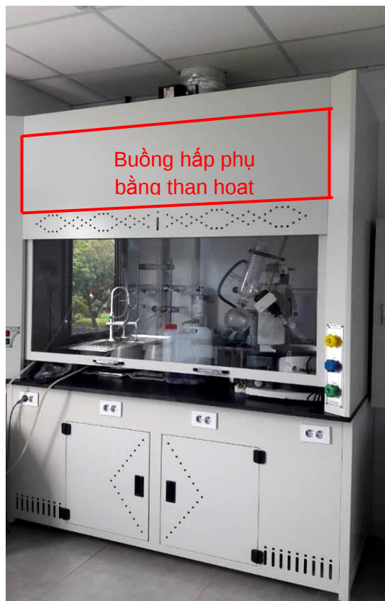
Hình 4.10. Tủ phân tích đi kèm hệ thống tháp hấp phụ hơi hóa chất bằng than hoạt tính.
