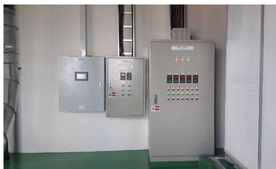
Hình 3.5. Tủ điện của hệ thống xử lý khí thải
