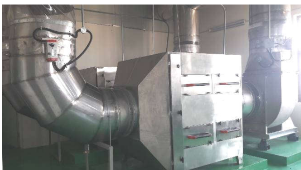
Hình 3.4. Hệ thống xử lý khí thải của dự án
