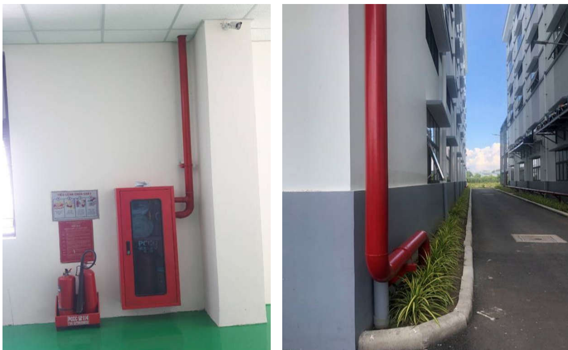
Hình 3.14. Một số hình ảnh minh họa hệ thống PCCC của công ty
